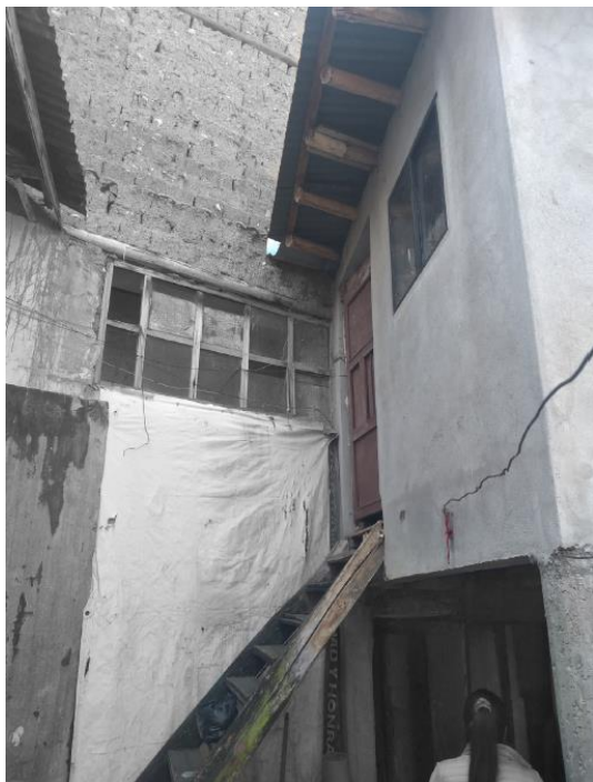
Figura 98: Edificación en precariedad Elaboración: Grupo de tesis
