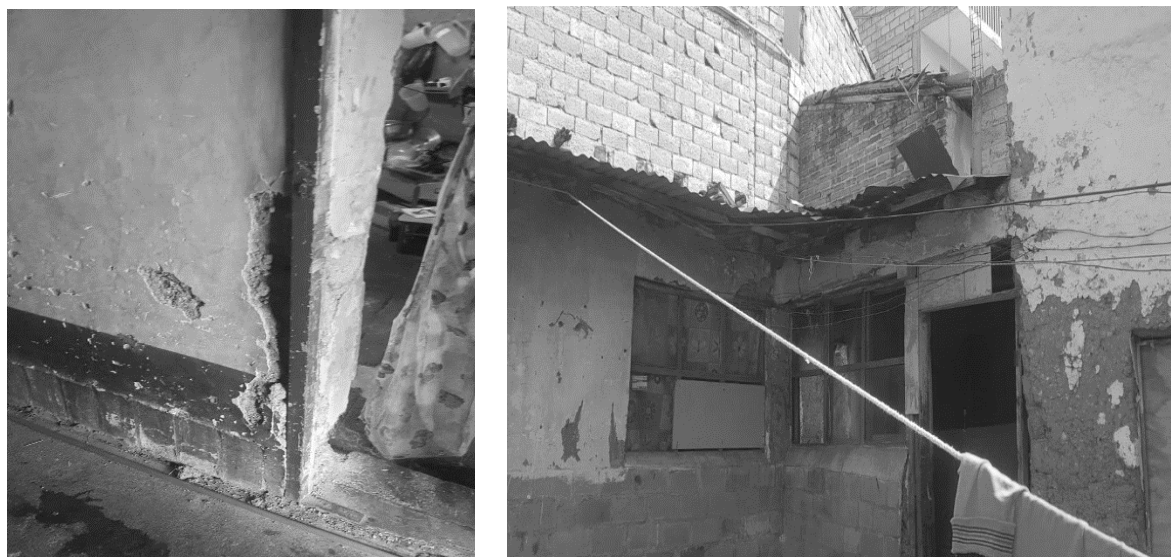
Figura 20: Deterioro de la edificación, sector El Vecino Elaboración: Grupo de tesis
