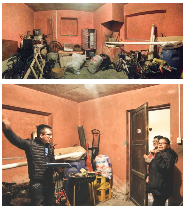
FIGURA 3.20: Fotografía 27 y 28: Vista interior del área de cocina de la vivienda de la Sra. Luisa Genovese (Estado actual). Fuente: Elaboración propia, 2019.
