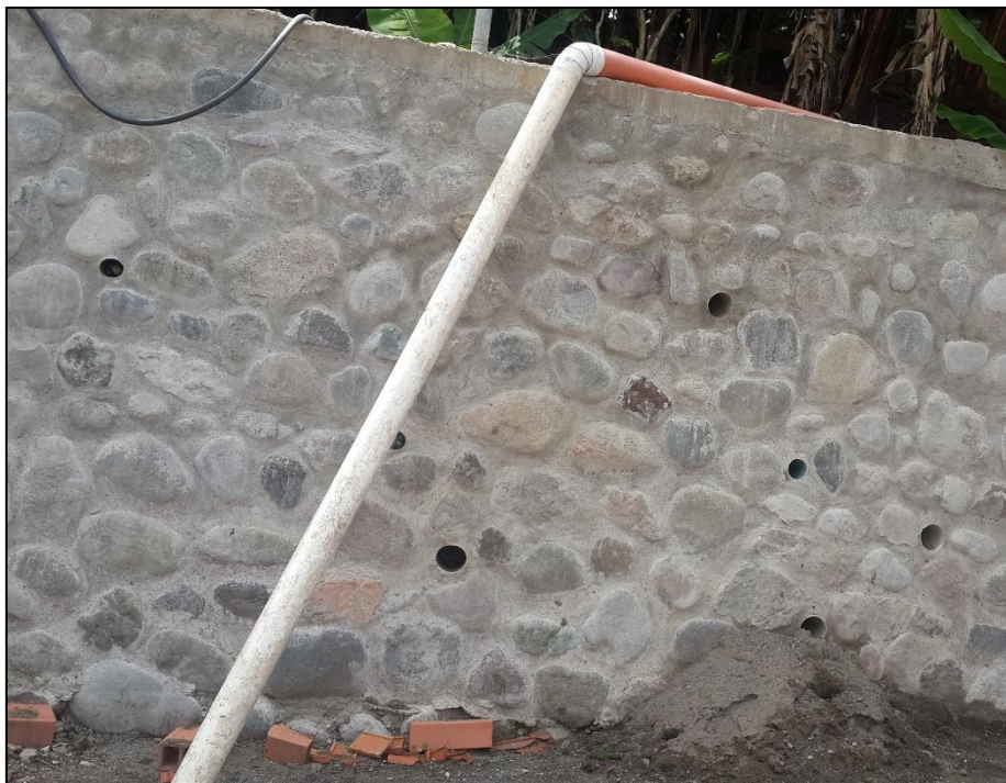
Imagen 13: Tubería del Agua al lado Izquierdo
