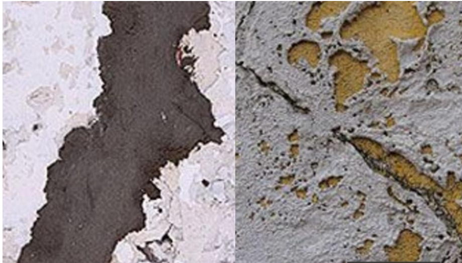
Figura 21: Fisuración y agrietamiento.
