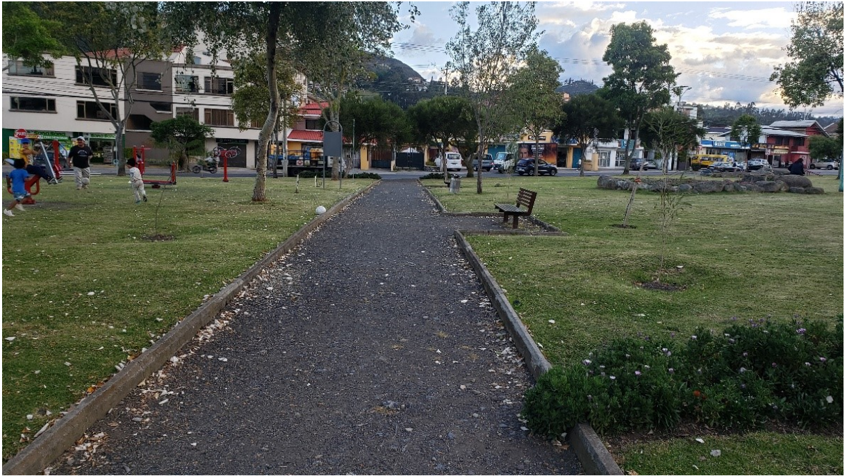
FIGURA 4.20: Estado de camineras parque Iberia Fuente: Propia
