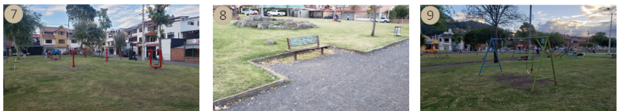
FIGURA 4.4: 7) Zona de ejercicios en buen estado, este espacio tiene poco tiempo desde su implementación. - 8) Mobiliario se presenta en mal estado y con graffitis. - 9) Juegos infantiles deteriorados y en desuso
