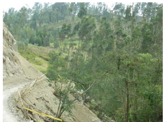
Foto. 4 Deslizamiento en la Vía. Elaboración: Jorge Eduardo Moyano Rios
