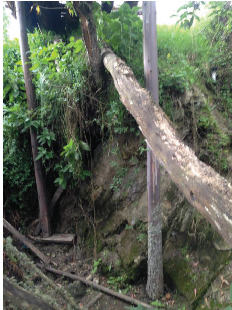
Foto A2.1.- Se pudo observar que las paredes de la quebrada han permanecido casi verticales y no se ha evidenciado huellas de socavación
