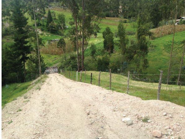
Foto A2.3.- relleno en el margen izquierdo del cauce
