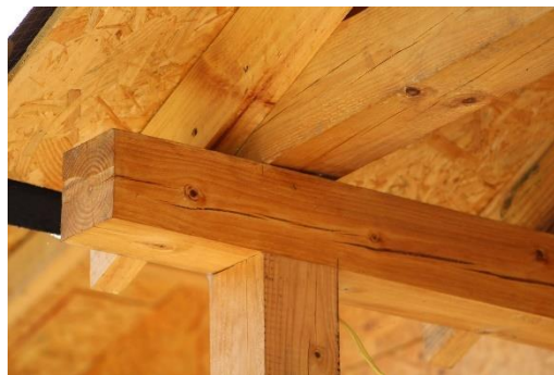
Fig. 61. Junta simple de viga columna con grietas.
