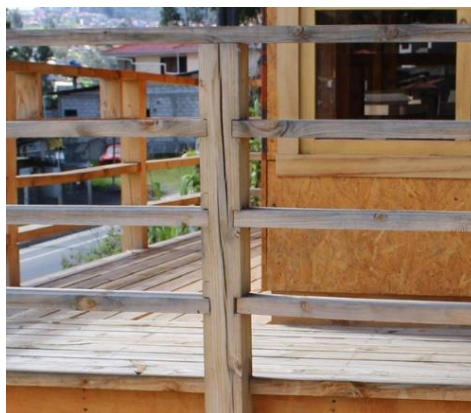
Fig. 63. Grietas causadas por la penetración de los clavos.
