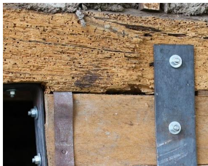
Fig. 56. Daños causados a la madera en la conexión por insectos
