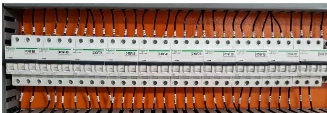
Figura 69. Distribución de los interruptores termo magnético. Fuente: Induglob
