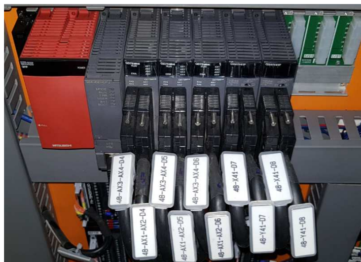
Figura 71. Conexión del controlador (PLC-Mitsubishi) Fuente: Induglob.
