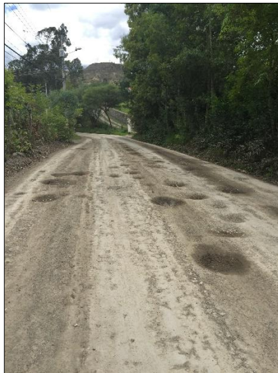
Procesos erosivos en suelos
