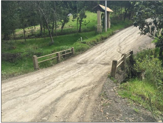
Deterioro de obra civil
