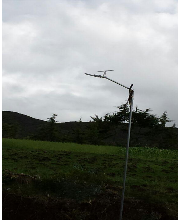
Fig.58 Luminaria de 30W colocada en el sendero.
