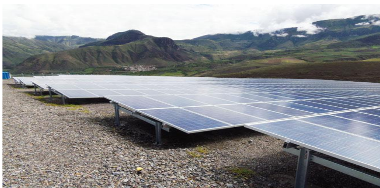
Fig.1 Planta Fotovoltaica Paragachi.
