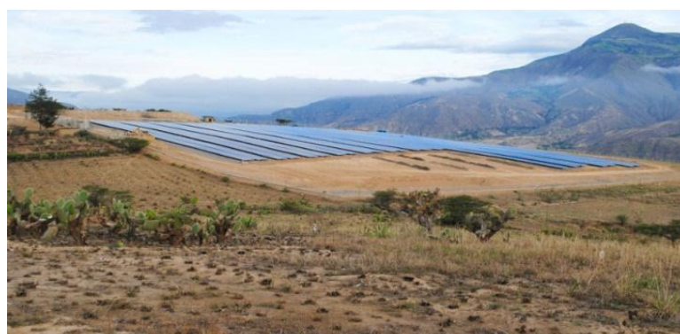
Fig.2 Planta Fotovoltaica Paragachi.
