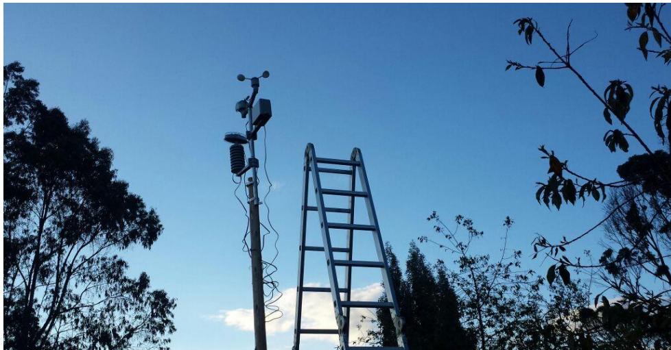
Fig.31 Estación Instalada en la Comunidad “PUNTAHACIENDA”.
