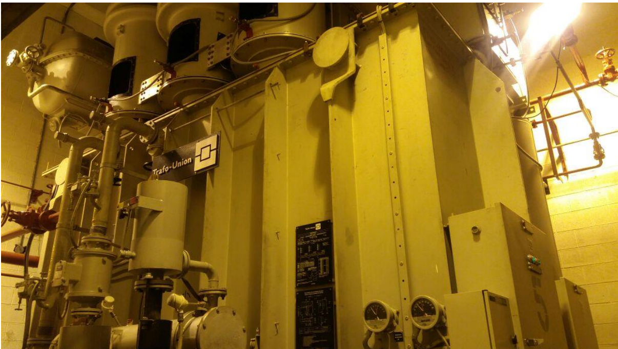
Figura No. 3. Transformador de Potencia de tres fases, 13.8kV/246.3kV, 134MVA.
