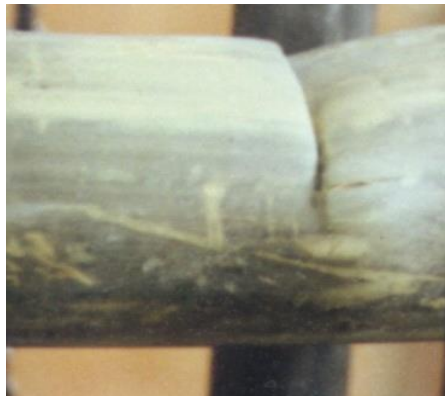
Figura 1: Falla a compresión
