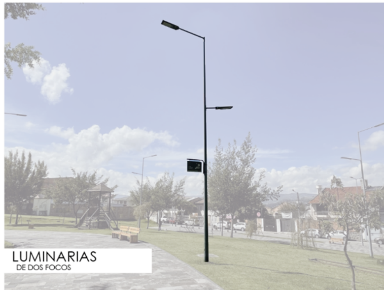
FIGURA 1.43: Luminarias de 2 focos. Fuente y elaboración: propia.
