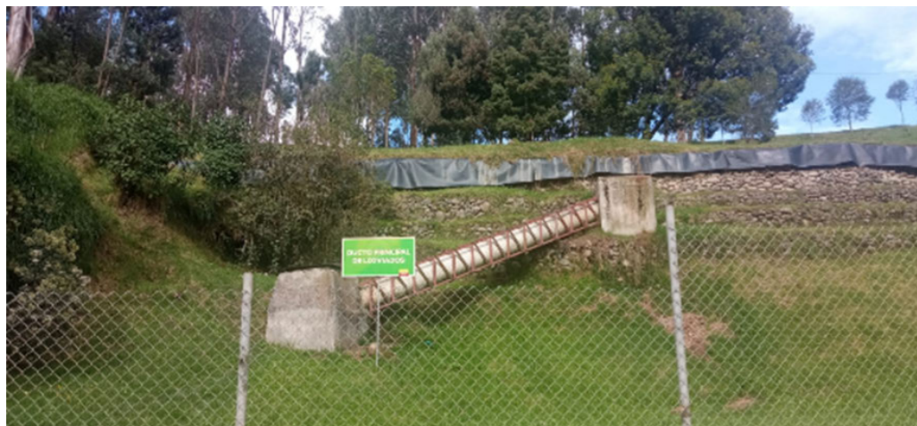
FIGURA 1.19: Ducto principal de lixiviados. Fuente: Autores, 2022.
