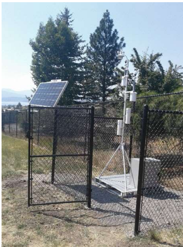
Figura 12. Estación meteorológica alimentada por energía solar fotovoltaica
