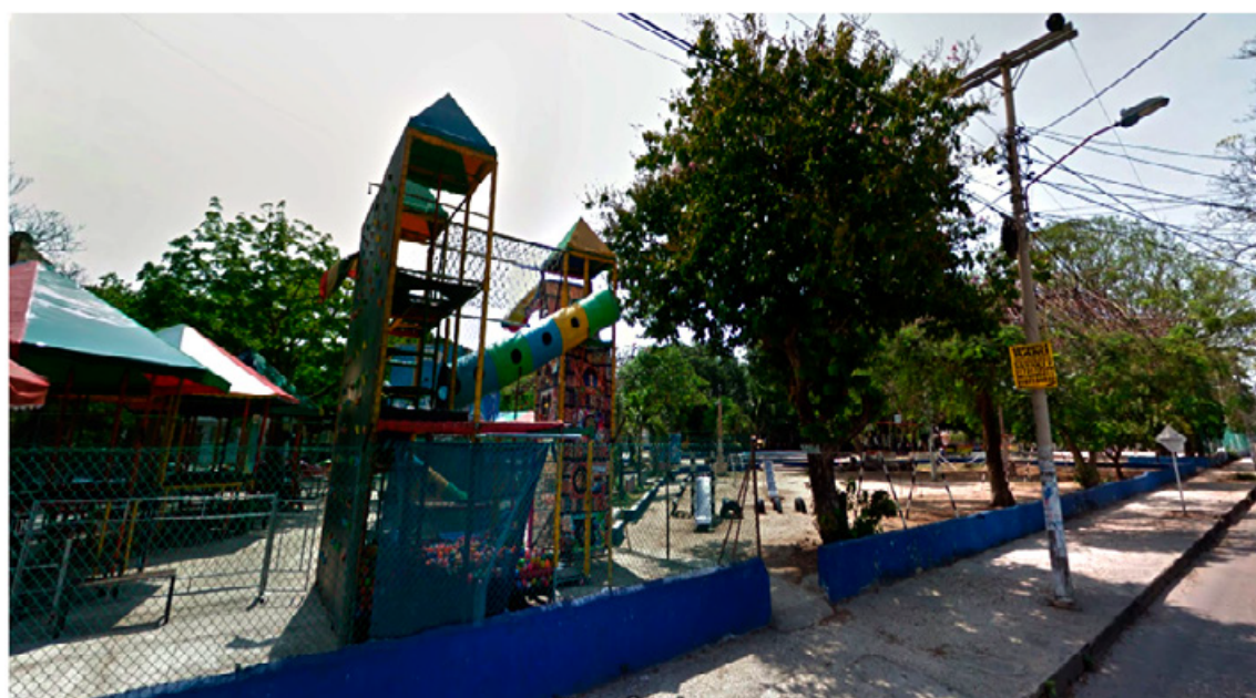
FIGURA 1.11: Juegos infantiles deteriorados
