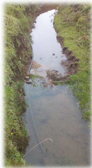
Imagen 10: Conexión clandestina encontrada durante una inspección. Fotografía: Juan Diego Vélez.
