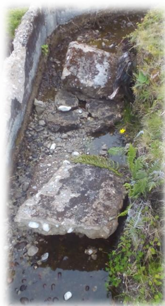
Imagen 6: Mal estado presentado por el paso de los años. Fotografía: Juan Diego Vélez.
