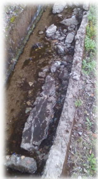
Imagen 8: Mal estado presente en el canal de conducción durante una inspección.
