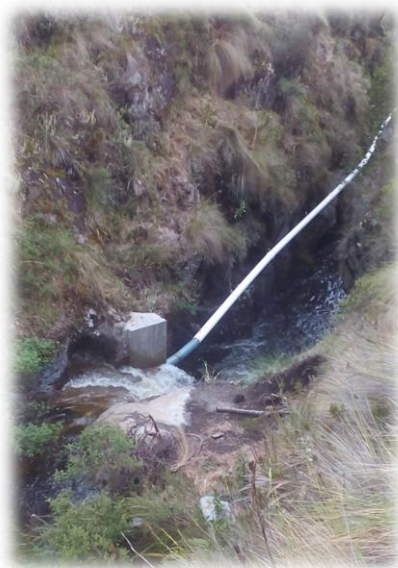
Imagen 11: Captación y tubería de conducción instalada durante la primera etapa. Fotografía: Juan Diego Vélez.
