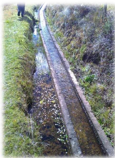
Imagen 2: Filtración presente en el canal de conducción Fotografía: Juan Diego Vélez.
