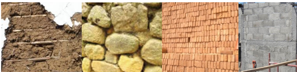
FIG. 1.52: Ejemplos de materialidad de las paredes en la vivienda cuencana. De izquierda a derecha: tierra, canto, ladrillo y bloque de hormigón
