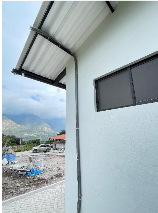
Figura 13. Bajante Cableado DC desde campo fotovoltaico hacia cuarto técnico
