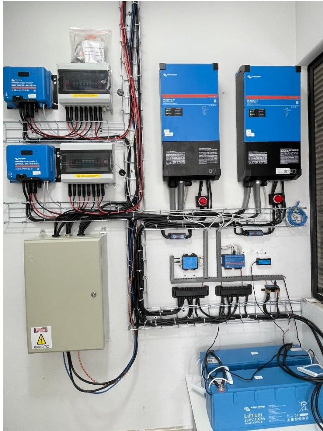
Figura 17. cableado DC y AC entre los equipos
