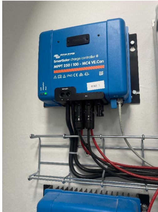
Figura 14. Cableado hacia controlador MPPT de carga
