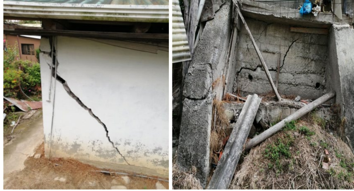
Figura 12: Estado actual de algunas viviendas existentes dentro de la zona de estudio.
