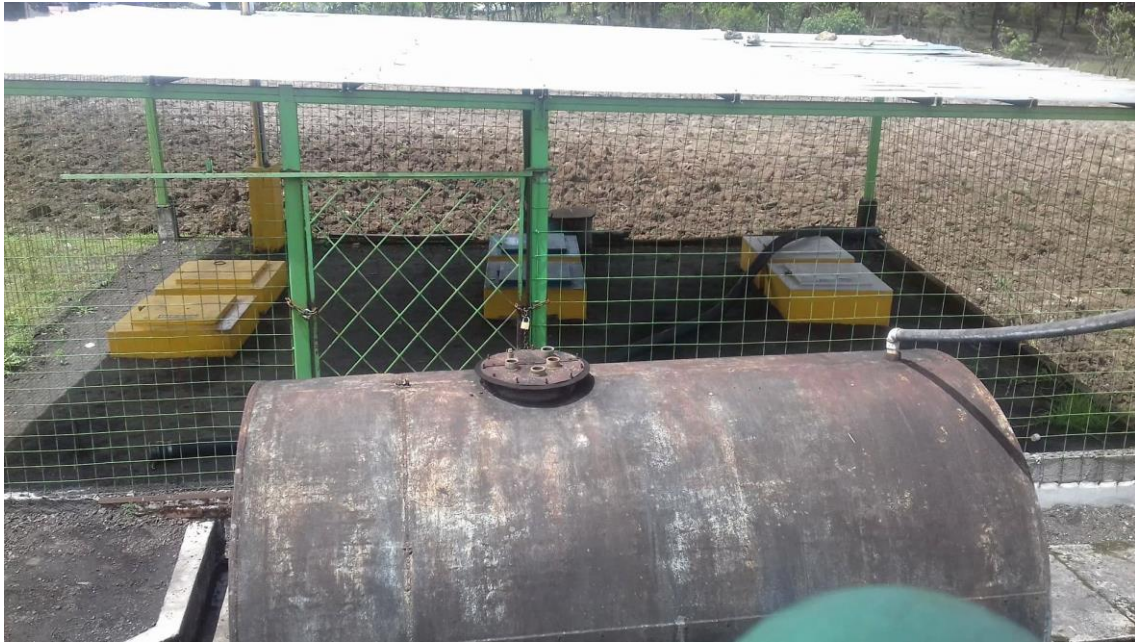
Tanques de almacenamiento de combustible
