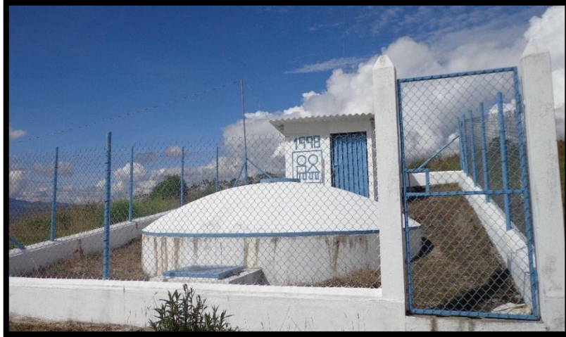
Figura 8. Tanque de Almacenamiento FUENTE: Levantamiento Fotográfico de campo ELABORACIÓN: Autor
