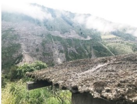
a). Techo de Fibrocemento cubierto por ceniza volcánica.
