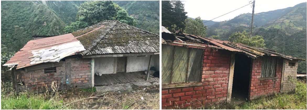
FIGURA 4.21: Cubiertas de Zinc cubiertas por óxido - Bilbao
