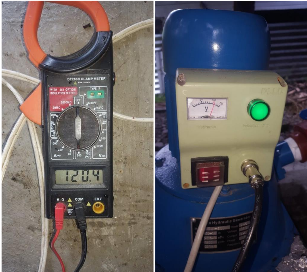
Fig. 60 Voltaje de salida del generador (Autores, 2018)
