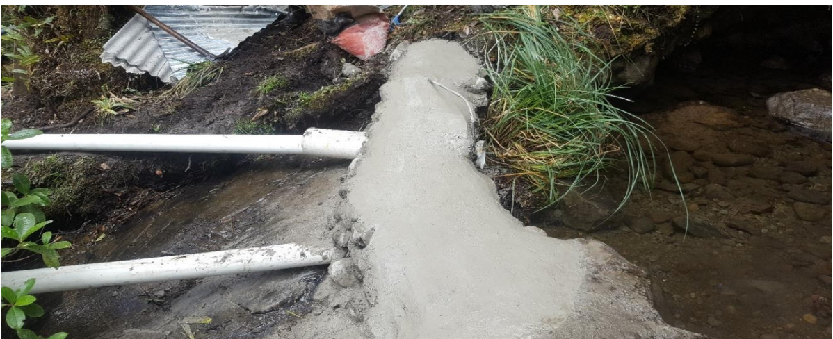
Fig. 43 Tuberías de salida de 6 y 4 pulgadas. (Autores, 2018)
