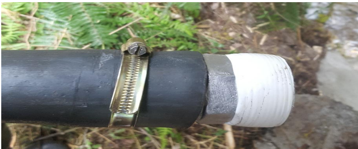
Fig. 55 conexión de la tubería de presión a la unión de aluminio. (Autores, 2018)
