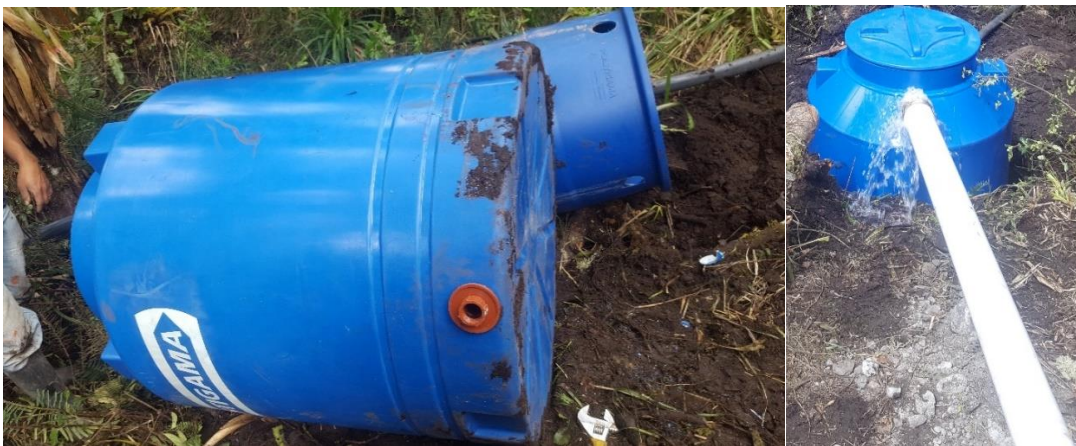
Fig. 45 Cámara de carga y desarenador (Autores, 2018)
