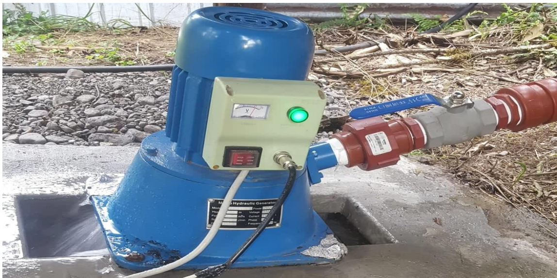
Fig. 59 Picocentral hidroeléctrica en funcionamiento.
