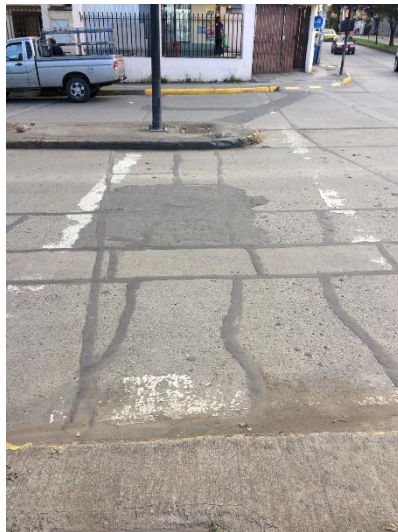
Ilustración 373: Fisuras selladas en la Turuhuayco sentido Sur - Norte. Fuente: La autora.
