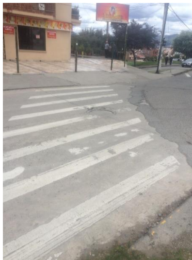
Ilustración 340: Desprendimiento de material en la Av. Héroes de Verdeloma. Fuente: La autora.
