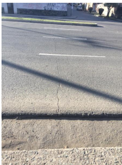
Ilustración 327: Fisura en la Av. De las Américas sentido Oeste - Este. Fuente: La autora.
