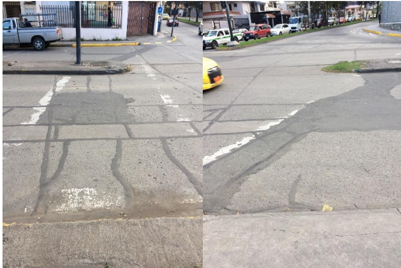
Ilustración 423: Desgaste en el cruce peatonal en la Turuhuayco sentido Sur - Norte. Fuente: La autora.
