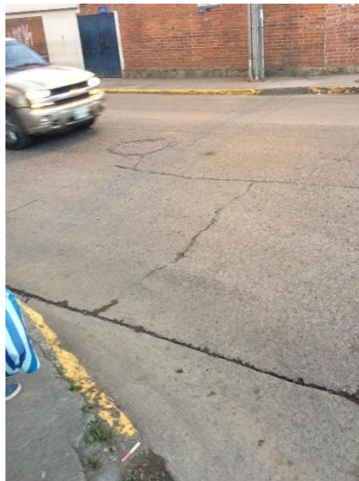
Ilustración 390: Fisura sin sellar en la Av. Don Bosco. Fuente: La autora.
