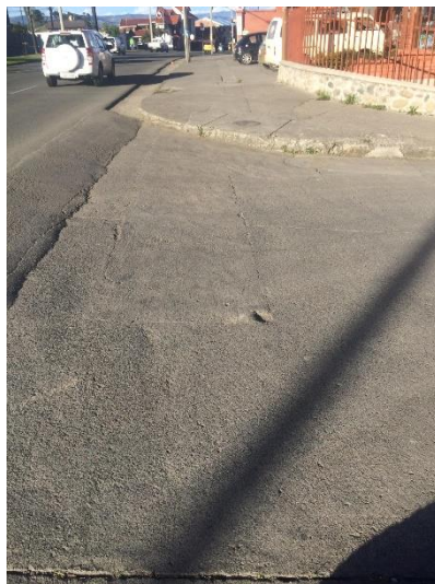
Ilustración 329: Pequeño desprendimiento de material en la calle Francisco Tamariz sentido Norte - Sur. Fuente: La autora.
