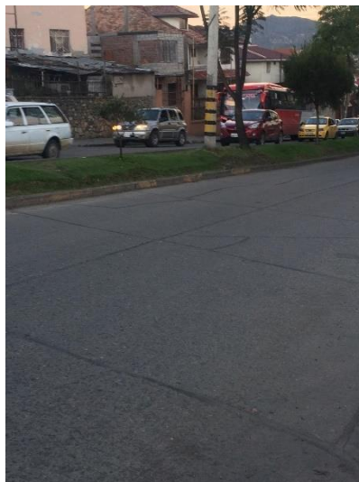
Ilustración 354: Fisuras selladas en la Turuhuayco sentido Sur - Norte. Fuente: La autora.
