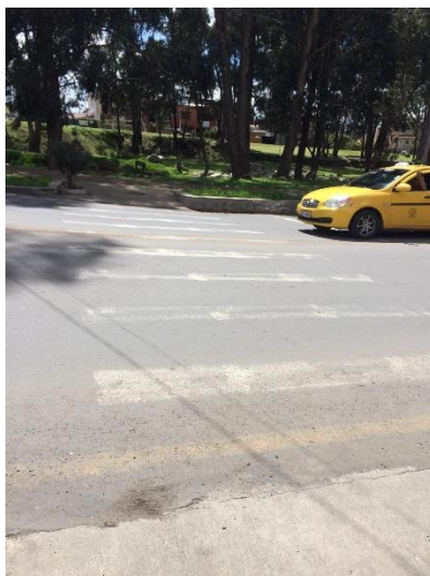
Ilustración 428: Señalización horizontal en mal estado en la Av. Primero de Mayo sentido Este - Oeste. Fuente: La autora.
