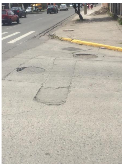
Ilustración 322: Hundimiento de la calzada y tapas de alcantarillado en la calle Nicanor Merchán.
