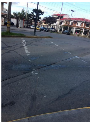
Ilustración 422: Desgaste cruce peatonal en la Turuhuayco sentido Norte - Sur. Fuente: La autora.
