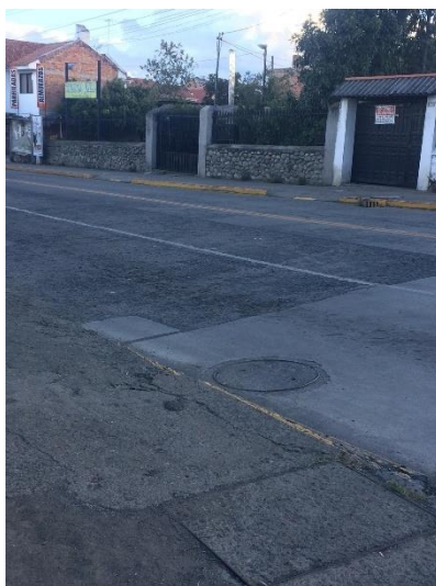
Ilustración 313: Falta de rugosidad en la calle Luis Cordero, evidencia de nivel de desgaste. Fuente: La autora
