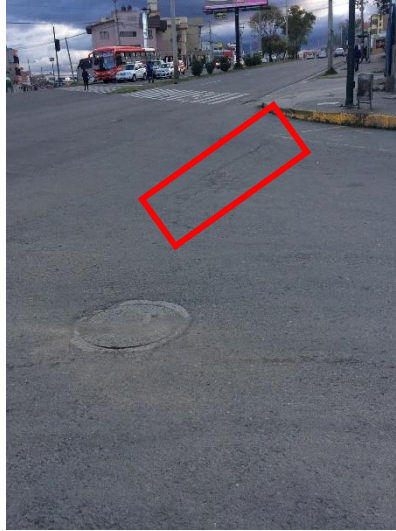
Ilustración 358: Hundimiento en la calle Obispo Miguel León. Fuente: La autora.
