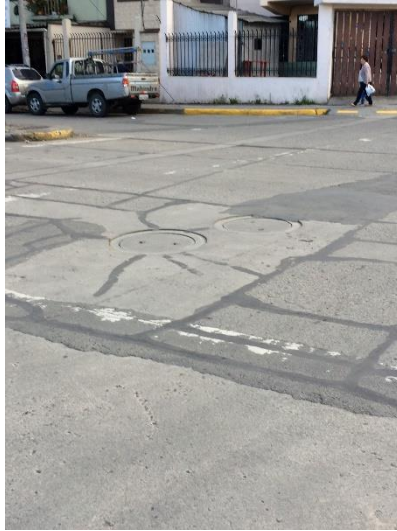
Ilustración 370: Hundimiento de tapas de alcantarillado en la intersección de la Calle Vieja y Turuhuayco. Fuente: La autora.
