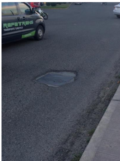
Ilustración 344: Hundimiento tapa de agua potable en la Av. De las Américas. Fuente: La autora.
