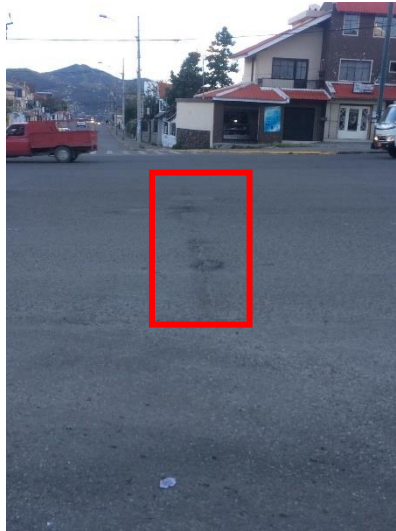
Ilustración 314: Grieta en la Av. De las Américas sentido Este - Oeste. Fuente: La autora.
