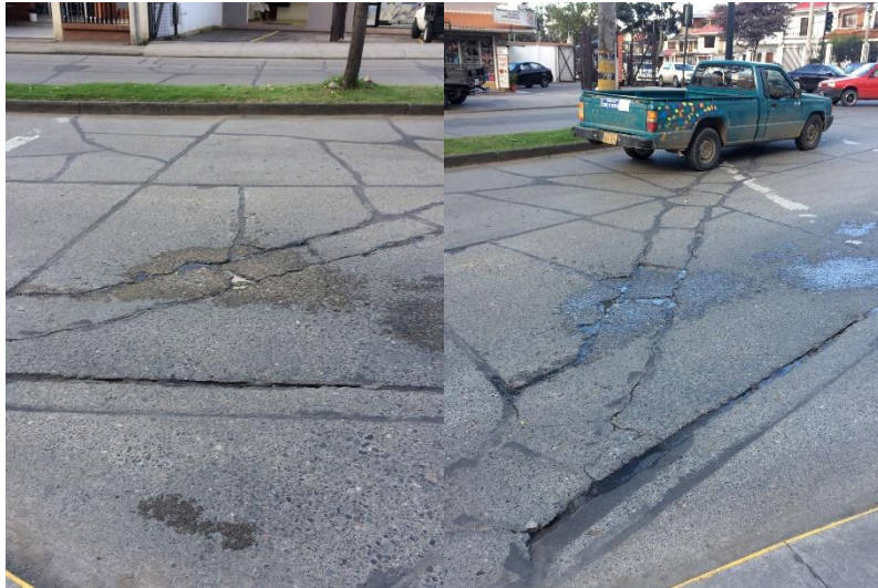
Ilustración 372: Fisuras profundas y sin tratar en la Turuhuayco sentido Norte - Sur. Fuente: La autora.
