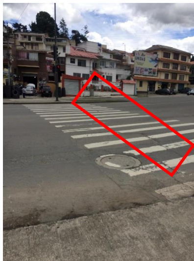
Ilustración 338: Fisura sin sellar en la Av. De las Américas sentido Sur - Norte. Fuente: La autora
