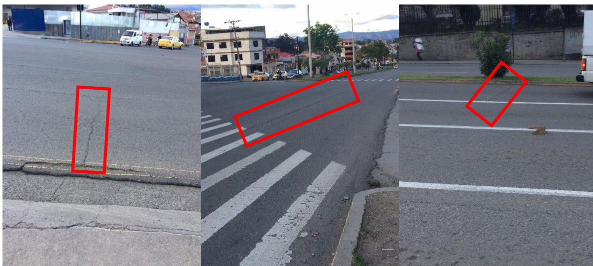
Ilustración 360: Fisuras sin tratar en la Av. De las Américas sentido Oeste – Este. Fuente: La autora.
