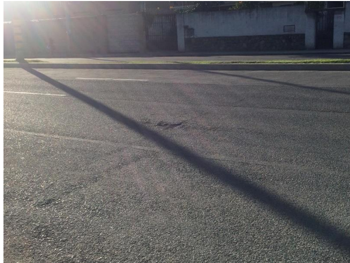
Ilustración 328: Desprendimiento de calzada en la Av. De las Américas sentido Oeste - Este. Fuente: La autora.
