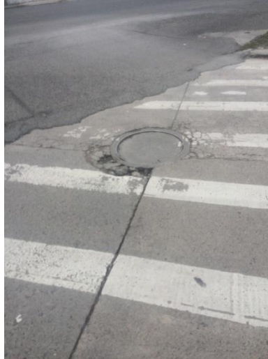
Ilustración 337: Tapa de alcantarillado hundida en la Av. Héroes de Verdeloma. Fuente: La autora.
