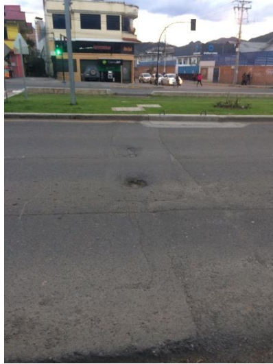
Ilustración 391: Huecos en la Av. De las Américas sentido Norte - Sur. Fuente: La autora.
