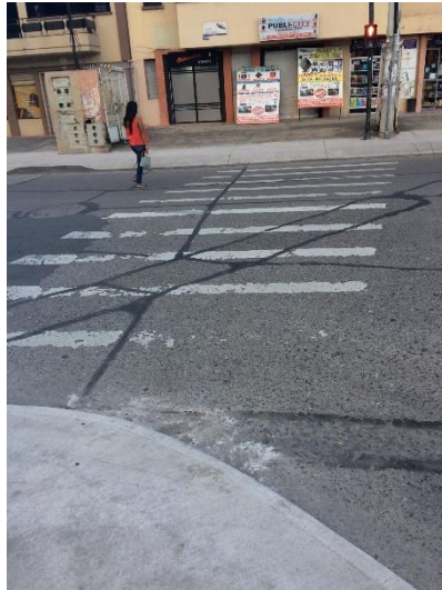
Ilustración 438: Cruce peatonal en mal estado en la Av. Don Bosco. Fuente: La autora.
