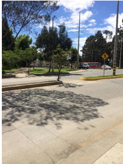
Ilustración 378: Rugosidad inadecuada en la Av. Primero de Mayo Fuente: La autora
