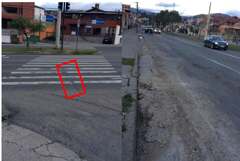
Ilustración 359: Grietas y fisuras en la Av. De las Américas sentido Este - Oeste. Fuente: La autora.
