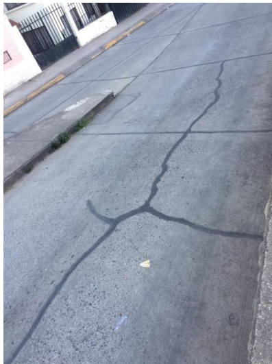
Ilustración 343: Mínima rugosidad existente en la Barrial Blanco sentido Sur – Norte Fuente: La autora
