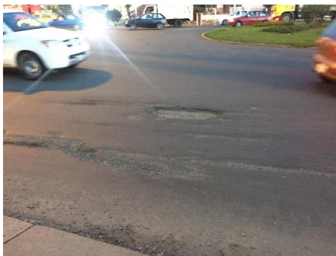
Ilustración 348: Desprendimiento de material en la Av. De las Américas sentido Este – Oeste. Fuente: La autora.
