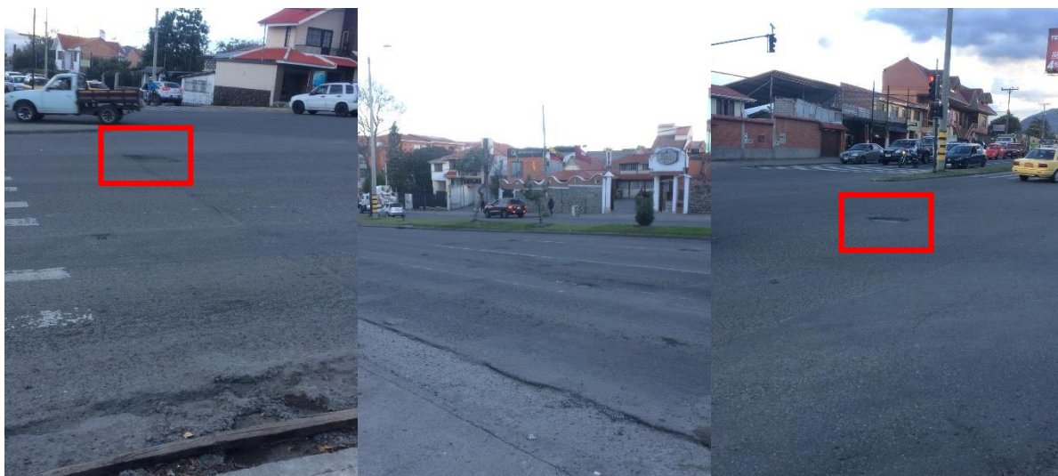
Ilustración 316: Desprendimientos de material en la Av. De las Américas sentido Este -Oeste. Fuente: La autora.
