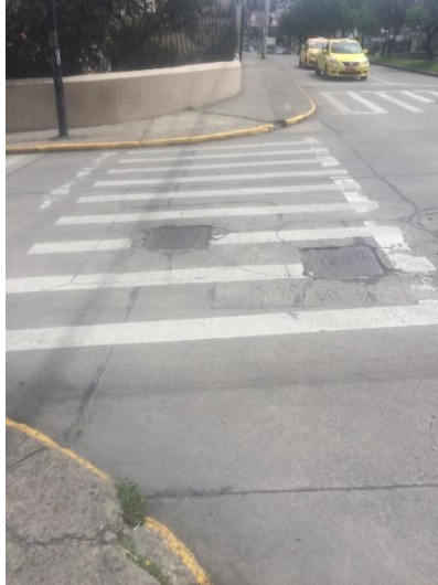
Ilustración 332: Hundimiento de tapas de agua potable en la calle Tarqui. Fuente: La autora.
