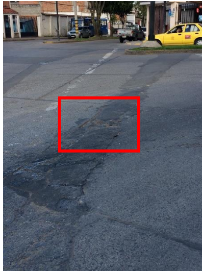
Ilustración 374: Desprendimientos en la Turhuayco sentido Norte - Sur. Fuente: La autora.
