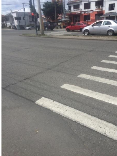
Ilustración 319: Nivel de rugosidad adecuado en la Av. De las Américas sentido Este - Oeste. Fuente: La autora.
