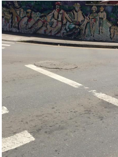
Ilustración 383: Hundimientos mal tratados en la Av. Primero de Mayo. Fuente: La autora.
