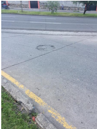
Ilustración 366: Hundimiento tapa de alcantarillado en la calle Armenillas. Fuente: La autora.
