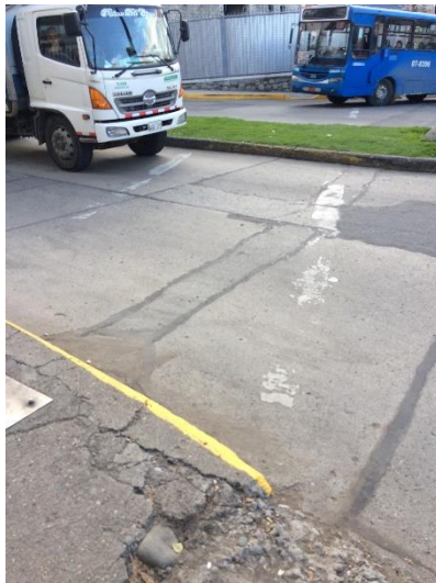
Ilustración 421: Desgaste de cruce peatonal en la Calle Vieja sentido Este - Oeste. Fuente: La autora.
