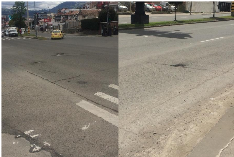
Ilustración 339: Huecos en la Av. De las Américas sentido Sur - Norte. Fuente: La autora.
