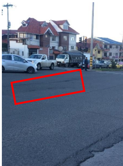
Ilustración 315: Grietas en la Av. De las Américas sentido Oeste - Este. Fuente: La autora
