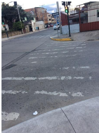
Ilustración 439: Cruce peatonal en mal estado en la calle Fernando de Aragón. Fuente: La autora.
