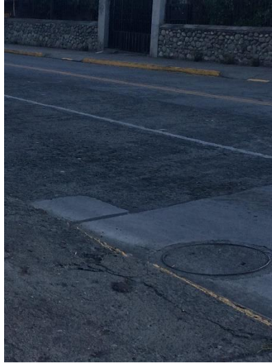
Ilustración 318: Desgaste y desprendimiento de material en la calle Luis Cordero. Fuente: La autora.
