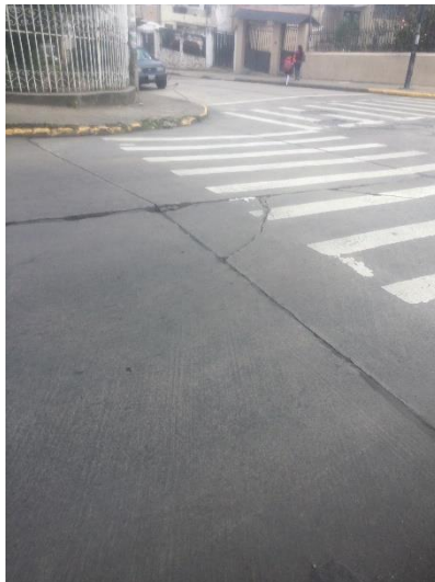
Ilustración 334: Fisura sin tratar en la Av. Héroes de Verdeloma sentido Oeste - Este. Fuente: La autora.
