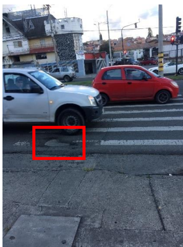
Ilustración 317: Desprendimiento de material en la Av. De las Américas sentido Oeste - Este. Fuente: La autora.
