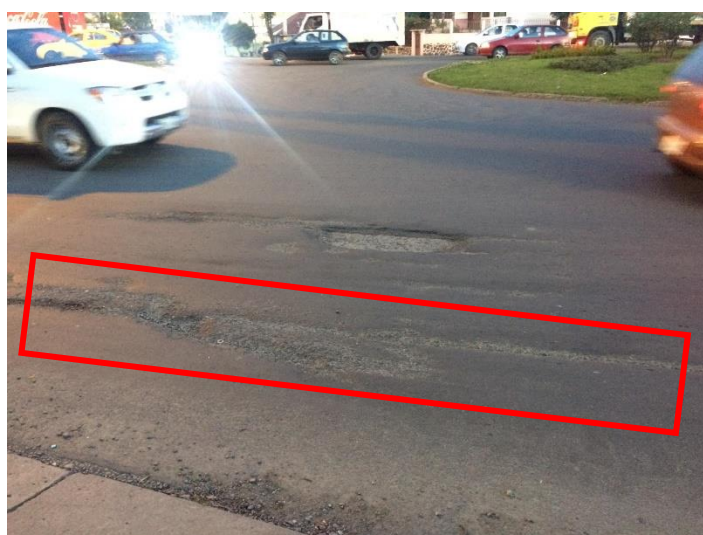
Ilustración 345: Grieta sin tratar en la Av. De las Américas sentido Este - Oeste. Fuente: La autora.
