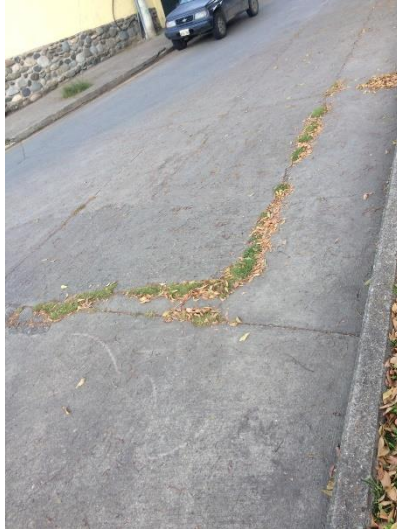
Ilustración 367: Fisura con vegetación en la calle Armenillas. Fuente: La autora.
