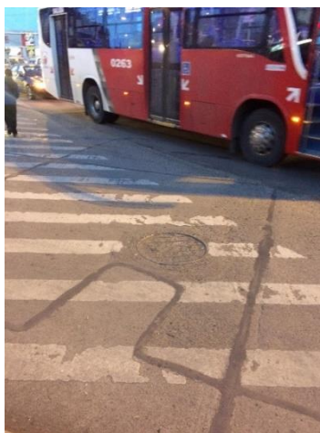
Ilustración 350: Desprendimiento de material en tapa de alcantarilla en la calle Barrial Blanco. Fuente: La autora.
