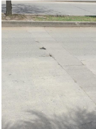
Ilustración 380: Desprendimiento de material en la Av. Primero de Mayo sentido Este - Oeste. Fuente: La autora.
