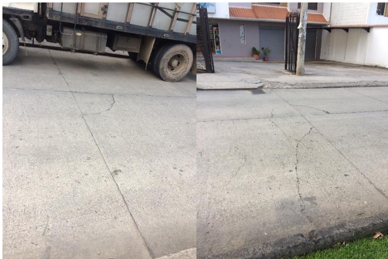
Ilustración 371: Fisuras sin tratar en la Calle Vieja sentido Este - Oeste. Fuente: La autora.
