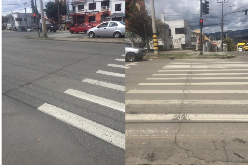
Ilustración 323: Fisuras sin tratar en la Av. De las Américas sentido Este - Oeste. Fuente: La autora.
