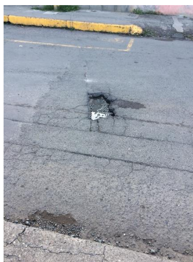
Ilustración 361: Fisuras en la calle Obispo Miguel León. Fuente: La autora.
