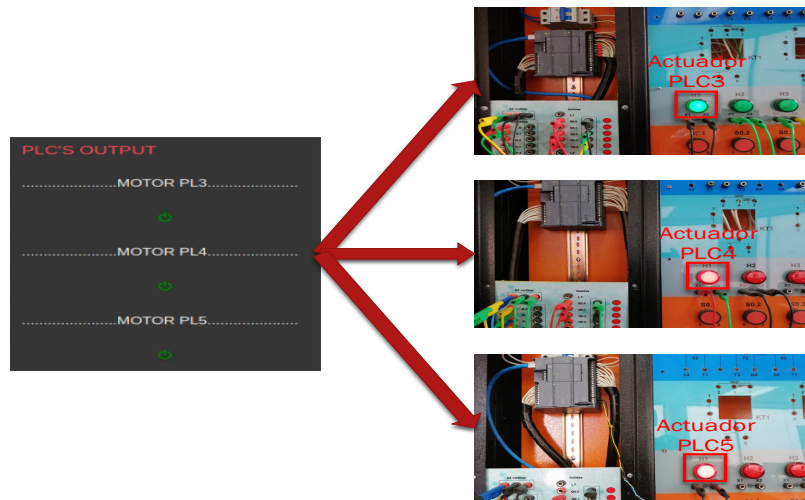
Figura 4.11: Control de salidas de PLCs desde Node-RED
