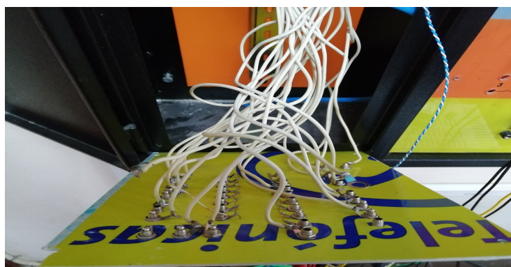
Figura 3.30: Panel de contactos del tablero de control
