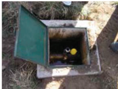
Gráfico No 38. Caja de válvulas Fuente: autor
