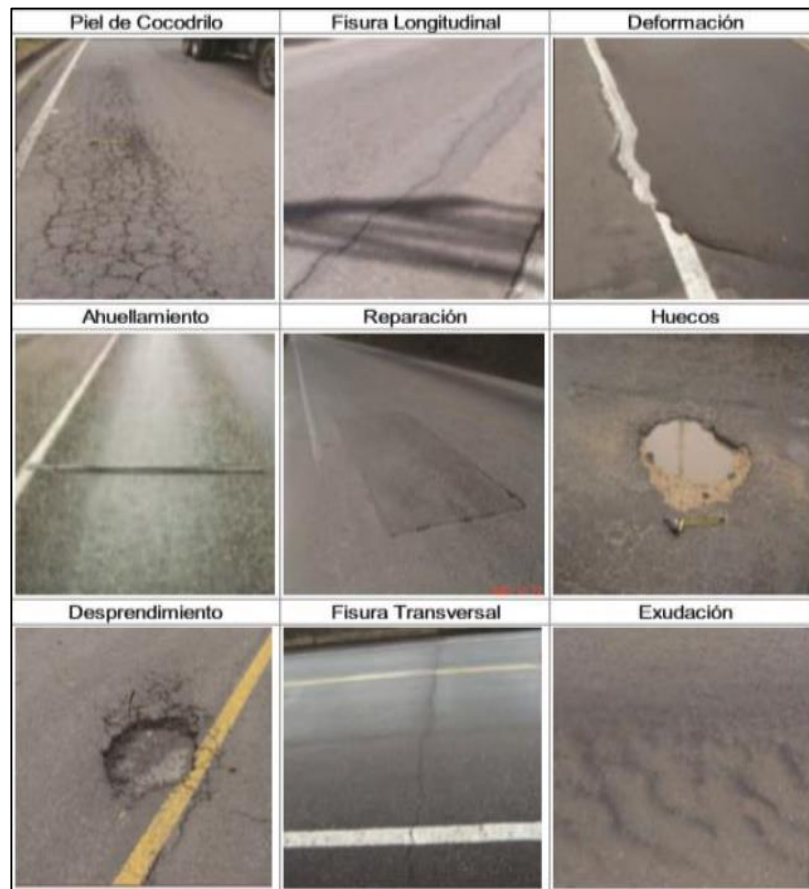
Gráfica 11. Daños en pavimentos flexibles
