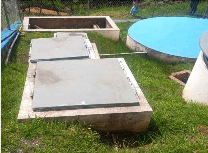
Captación de agua 4 - Pereña
