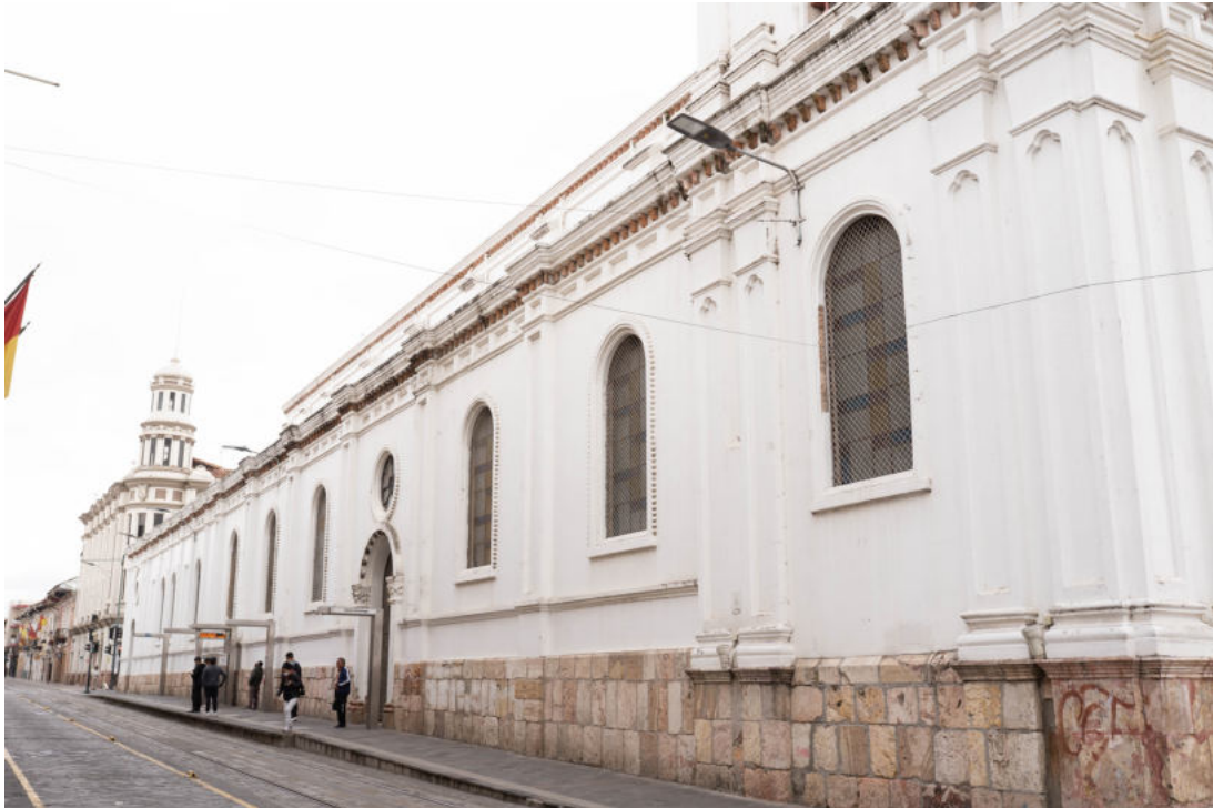
FIGURA 3.7: Afecciones en la fachada frontal. Fuente y Elaboración : Autora.
