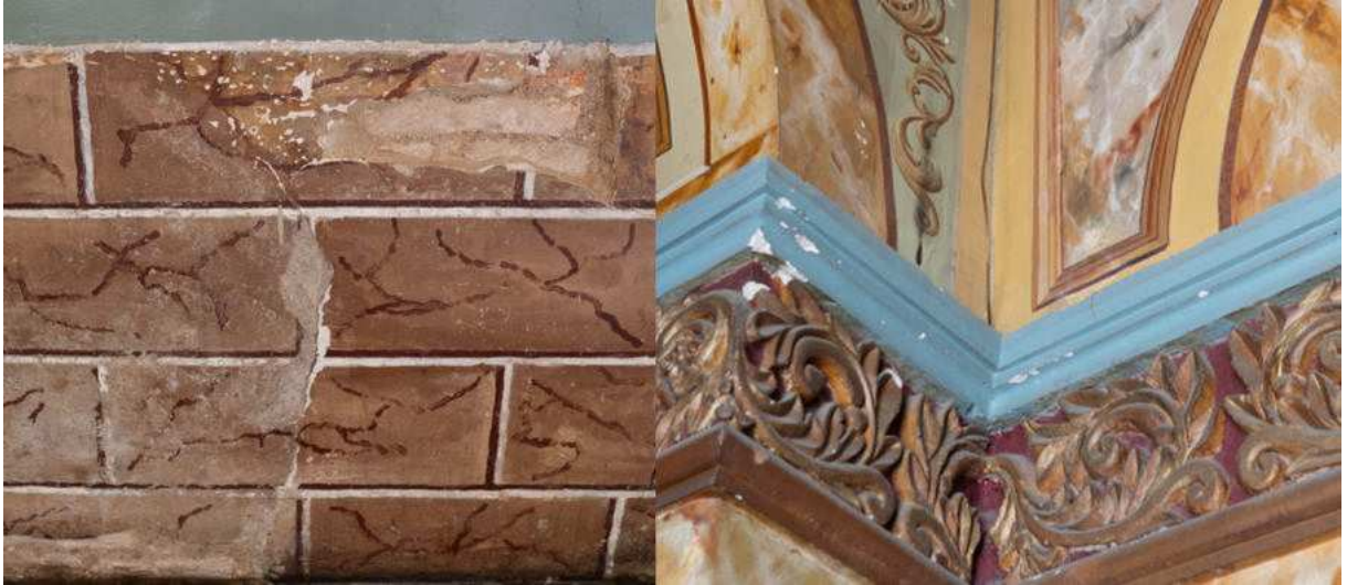
FIGURA 3.15: Afecciones internas por desprendimiento. Fuente: Ayala & Pulla (2022) .
