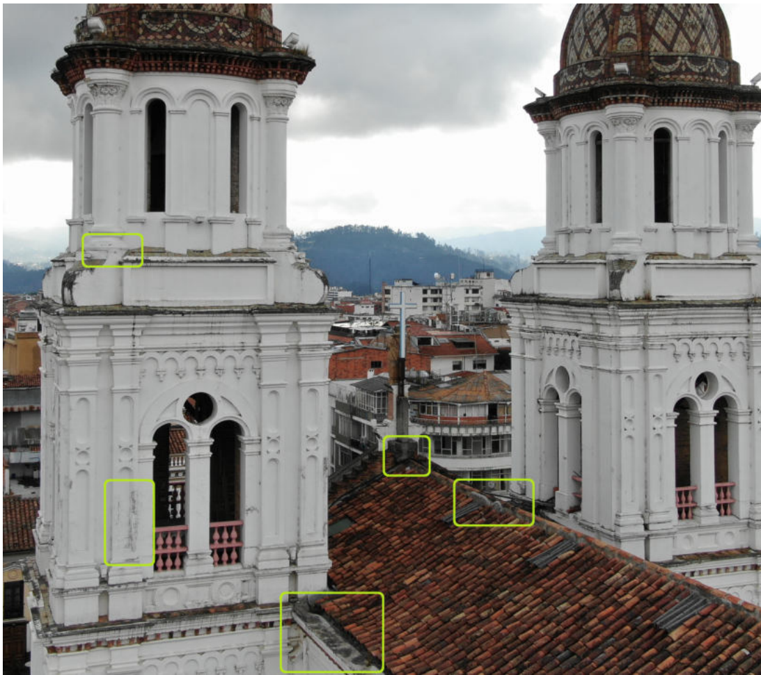
FIGURA 3.4: Afecciones en cubierta. Fuente: Ayala & Pulla (2022)
