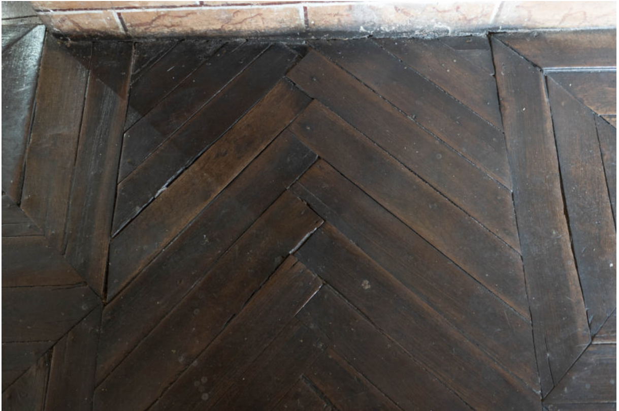
FIGURA 3.12: Deformación y levantamiento del piso interior. Fuente: Ayala & Pulla (2022) .
