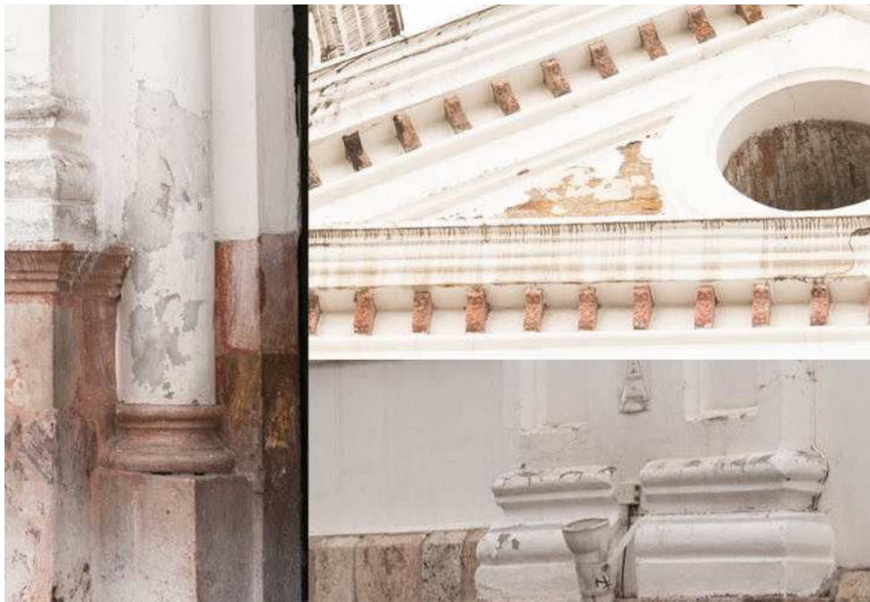
FIGURA 3.17: Afecciones externas por desprendimiento. Fuente: Ayala & Pulla (2022).
