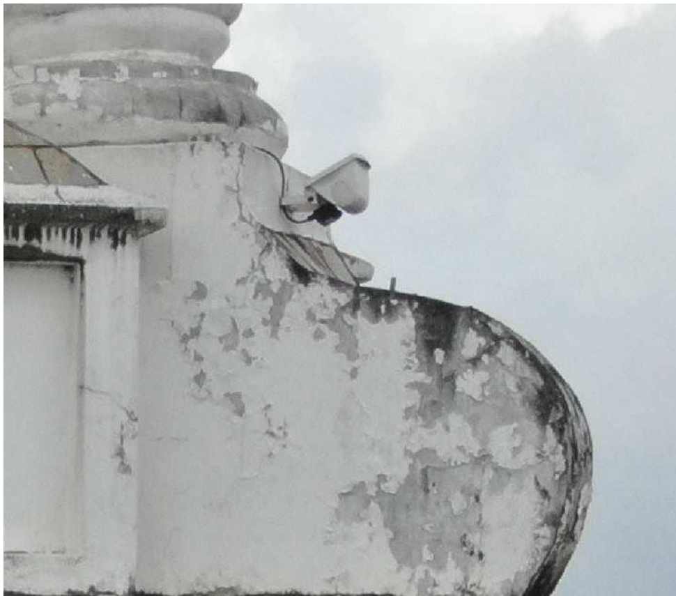
FIGURA 3.18: Afecciones en las cúpulas por desprendimiento. Fuente: Ayala & Pulla (2022).
