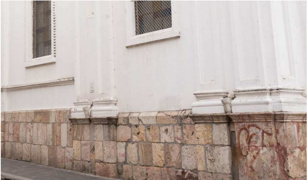
FIGURA 3.22: Afecciones externas por colonización biológica. Fuente: Ayala & Pulla (2022) .
