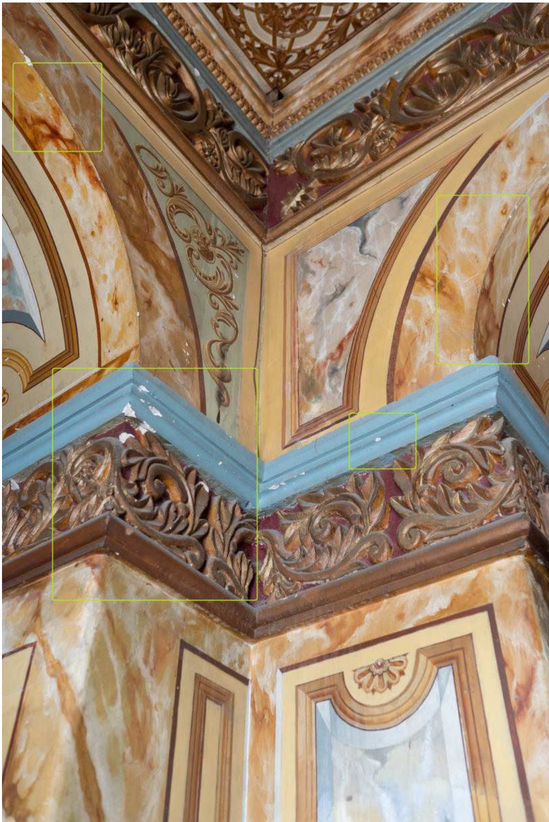
FIGURA 3.14: Afecciones en columnas y cielo raso. Fuente: Ayala & Pulla (2022).
