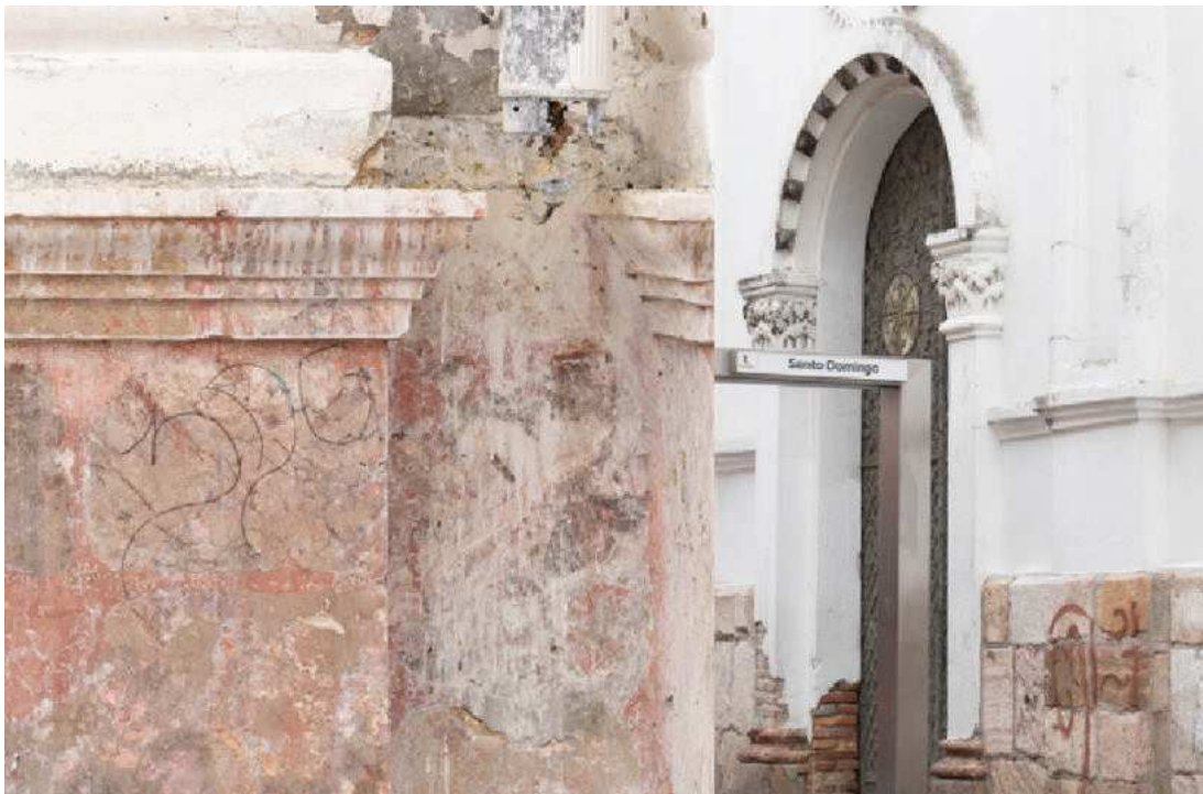
FIGURA 3.8: Afecciones en el exterior. Fuente y Elaboración : Autora.
