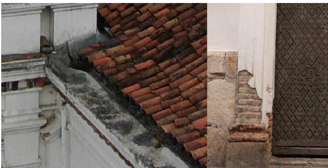
FIGURA 3.5: Afecciones en cubierta. Fuente: Ayala & Pulla (2022)
