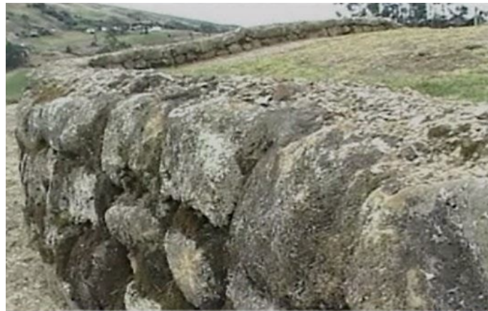
FIGURA 1.13: Deterioro de uno de los muros del Complejo Ingapirca.
