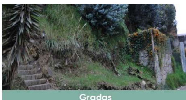
FIGURA 1.4: Graderíos en mal estado, debido a la falta de mantenimiento. Fuente y Elaboración: https://dspace.ucacue.edu.ec/handle/ucacue/1244 .
