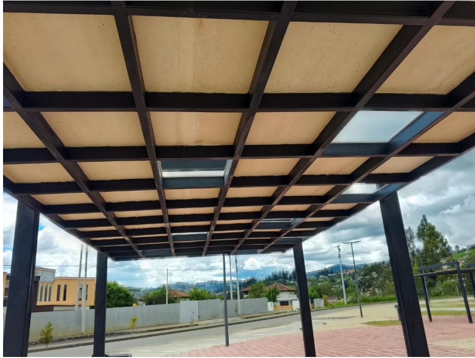
Figura 51: Destrucción de la cubierta de las pérgolas
