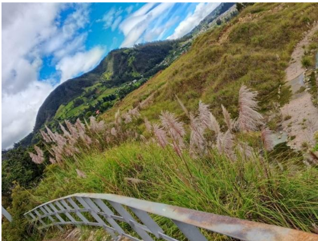
Figura 45: Pasamanos metálicos oxidados
