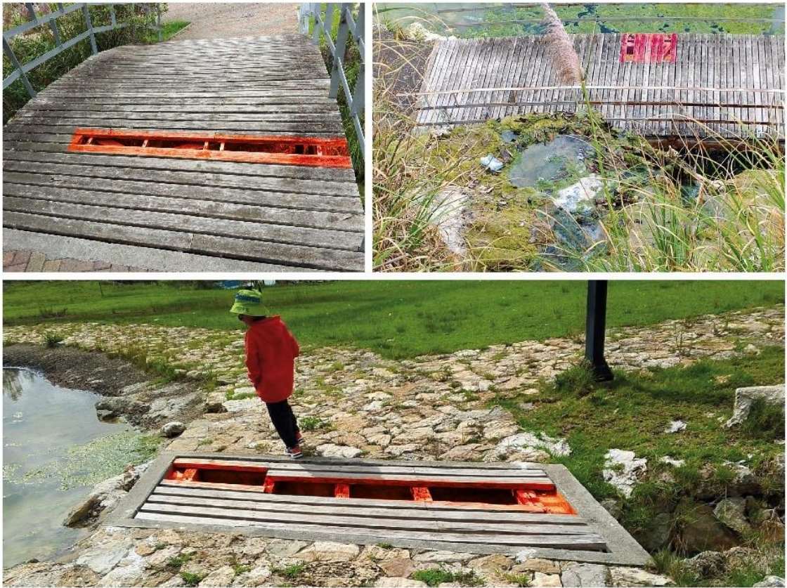
Figura 44: Puentes sin piezas de madera y destruidos
