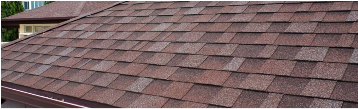
FIGURA 12. CUBIERTA ELABORADA CON TEJA ASFÁLTICA. FUENTE: (BONURA , Y OTROS, 2011)
