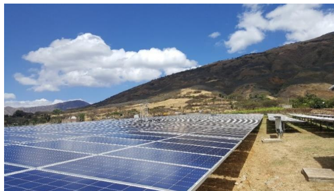
Fig. 43 Planta Fotovoltaica San Pedro - Loja
