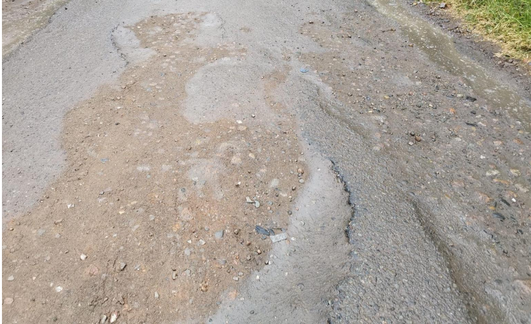
Ilustración 26: Abscisa 1+200 (Bacheos y desgaste de la capa granular)
