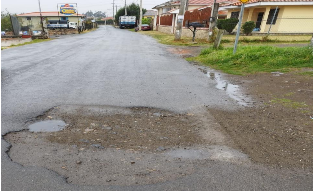
Ilustración 22: Abscisa 0+450 (Bacheos y desgaste de la capa granular)
