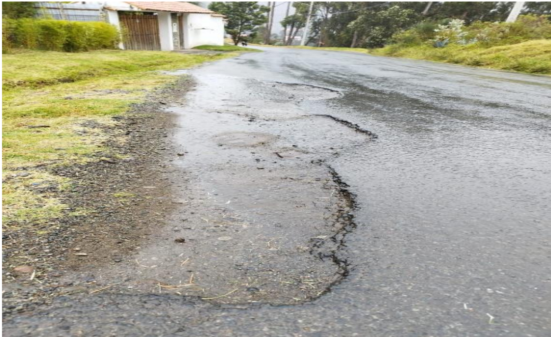
Ilustración 20: Abscisa 0+350 (Bacheos y desgaste de la capa granular)
