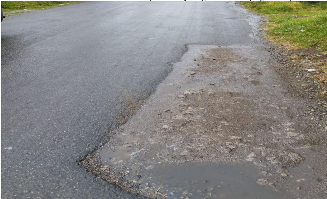
Ilustración 23: Abscisa 0+700 (Bacheos y desgaste de la capa granular)
