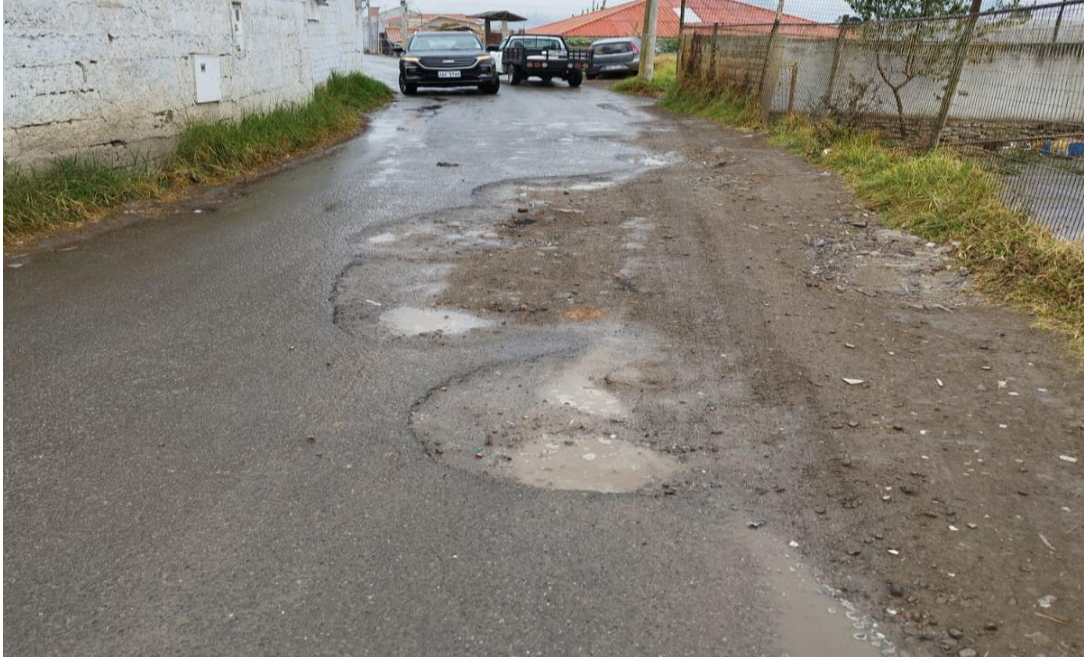
Ilustración 24: Abscisa 1+050 (Bacheos y desgaste de la capa granular)
