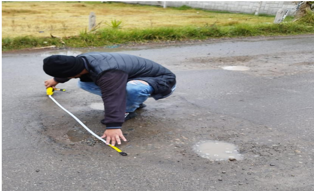
Ilustración 25: Abscisa 1+100 (Bacheos y desgaste de la capa granular)
