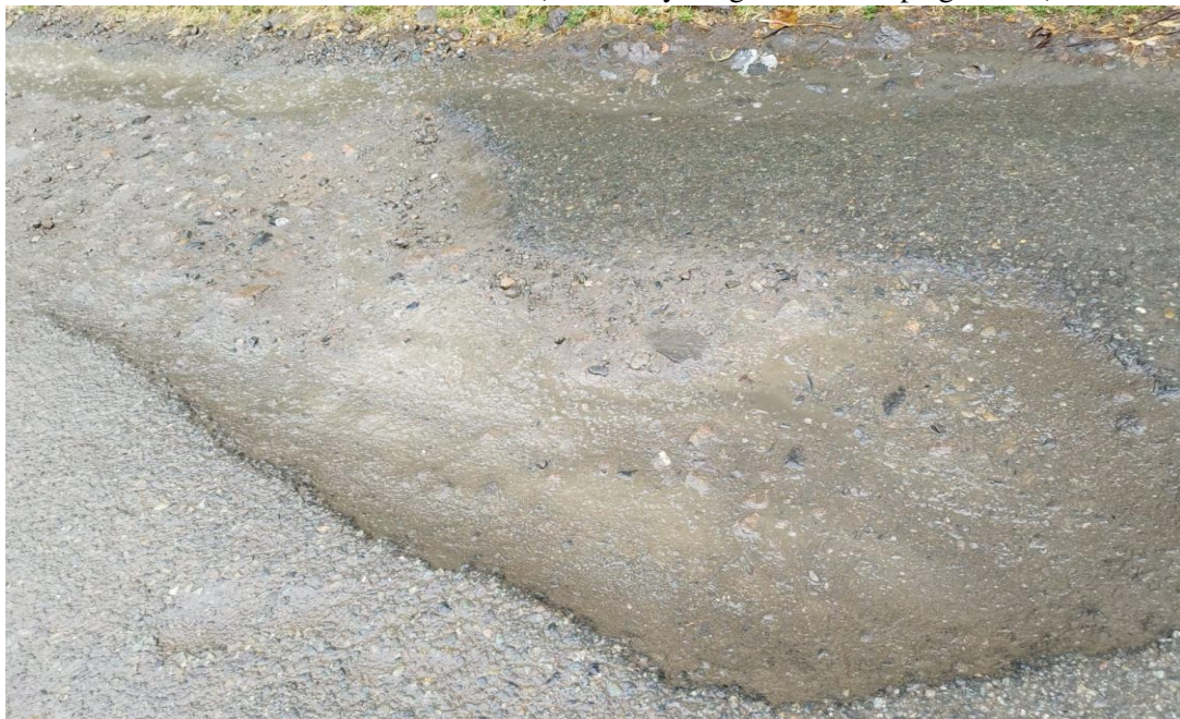
Ilustración 27: Abscisa 1+300 (Bacheos y desgaste de la capa granular)
