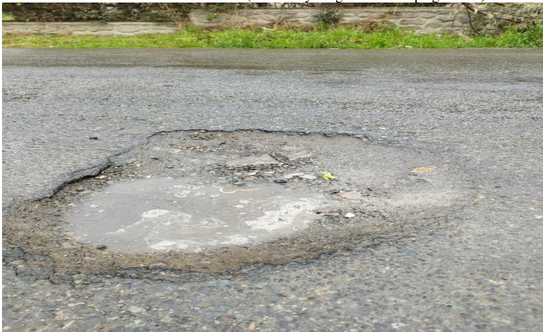
Ilustración 21: Abscisa 0+400 (Bacheos y desgaste de la capa granular)
