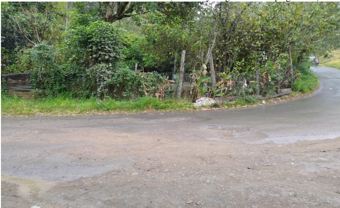
Ilustración 19: Abscisa 0+100 (Bacheos y desgaste de la capa granular)
