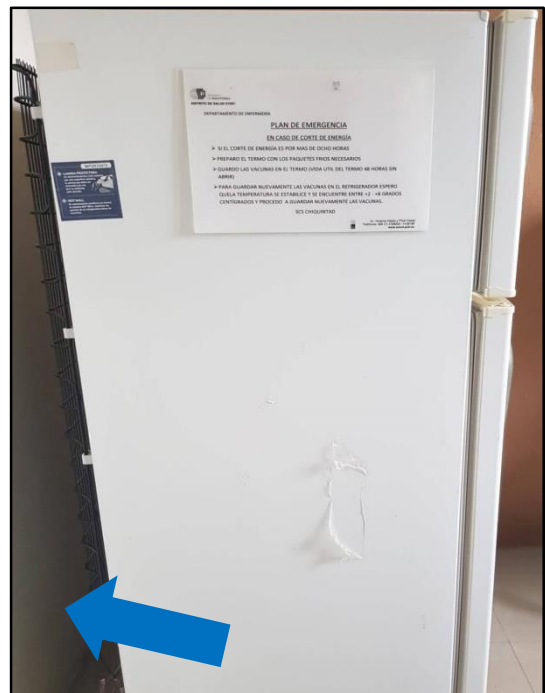
Fig. 18: En esta imagen se puede observar la distancia de 15cm entre la pared y la refrigeradora.
