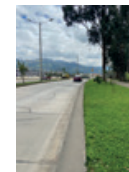
Estado del pavimento de la Av. 1 de Mayo Fuente: propia.
