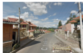
Estado del pavimento de la calle 1 de septiembre Fuente: google maps.
