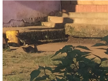
FOTOGRAFÍA N°3.1.7.1.1 Suelo de cemento
