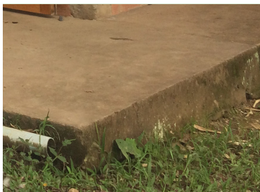
FOTOGRAFÍA N°3.1.6.1.1 Suelo de cemento
