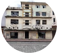
Figura 180. Mal estado en las fachadas Fuente: Elaboración propia
