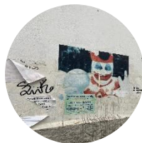
Figura 169. Mal estado en las fachadas Fuente: Elaboración propia
