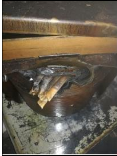
Figura 4.4.3 Transformador fallado por sobrecarga
