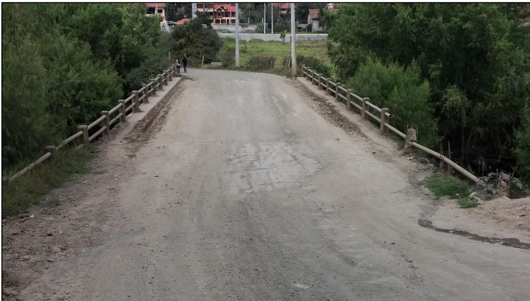
Figura 105. Estado deteriorado de las barandas, área de circulación peatonal como vehicular deficiente. Fuente: Autor
