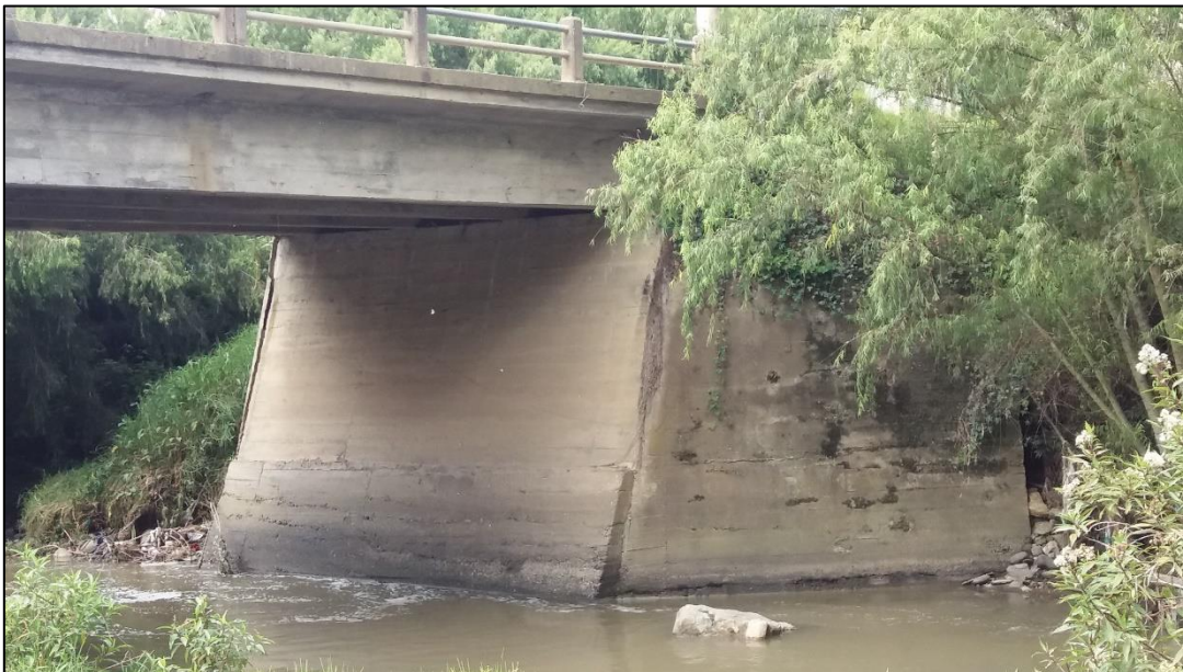
Figura 107. Cauce del río en el estribo izquierdo del puente. Fuente: Autor
