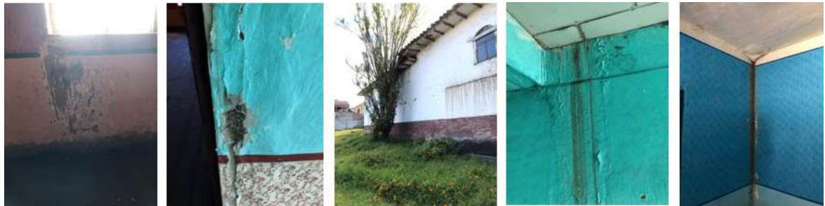
FIGURA 2.19: Algunas lesiones patológicas en mampostería
