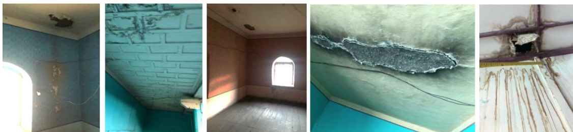
FIGURA 2.13: Lesiones patológicas causadas por humedad en el cielo raso en P.A.
