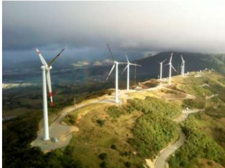
Figura 25: Central Eólica Villonaco (16.5 MW). Fuente: (Ministerio de Energía y Minas, 2022)
