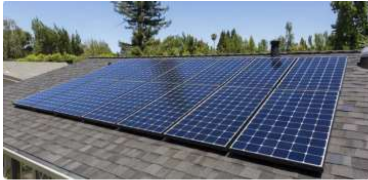
Figura 15: Paneles Solares Monocristalinos. Fuente: (E. F. C. Solar, 2021)
