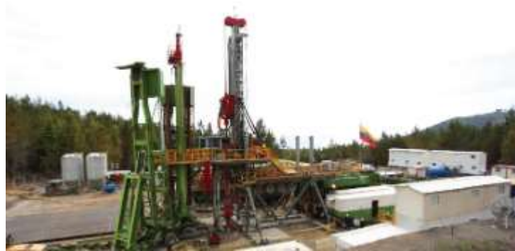
Figura 8: Energía Geotérmica-Central de Chachimiro. Fuente: (Ministerio de Energía y Minas, 2019)
