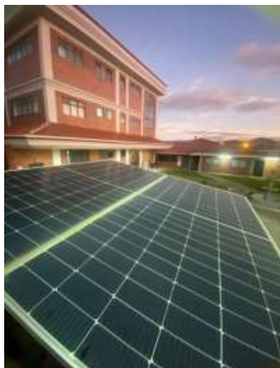
Figura 14: Panel Solar ubicado en la facultad de Ingeniería, Industria y Construcción UCACUE. Fuente: El Autor
