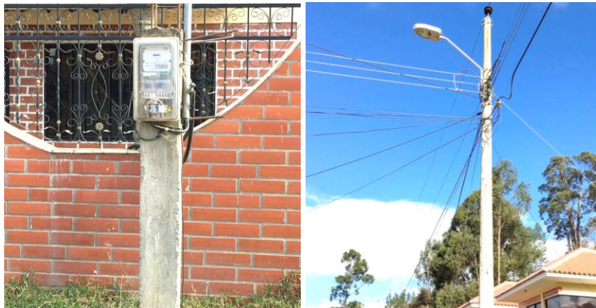
Figura 115: Luz eléctrica y alumbrado público en el sector Bellavista. Ochoa, J. (2017). [Fotografía]. Azogues, Ecuador.
