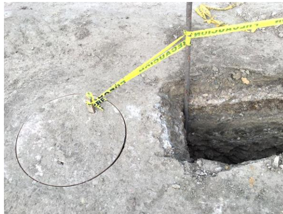
Figura 114: Alcantarillado en el sector Bellavista. Ochoa, J. (2017). Azogues, Ecuador.
