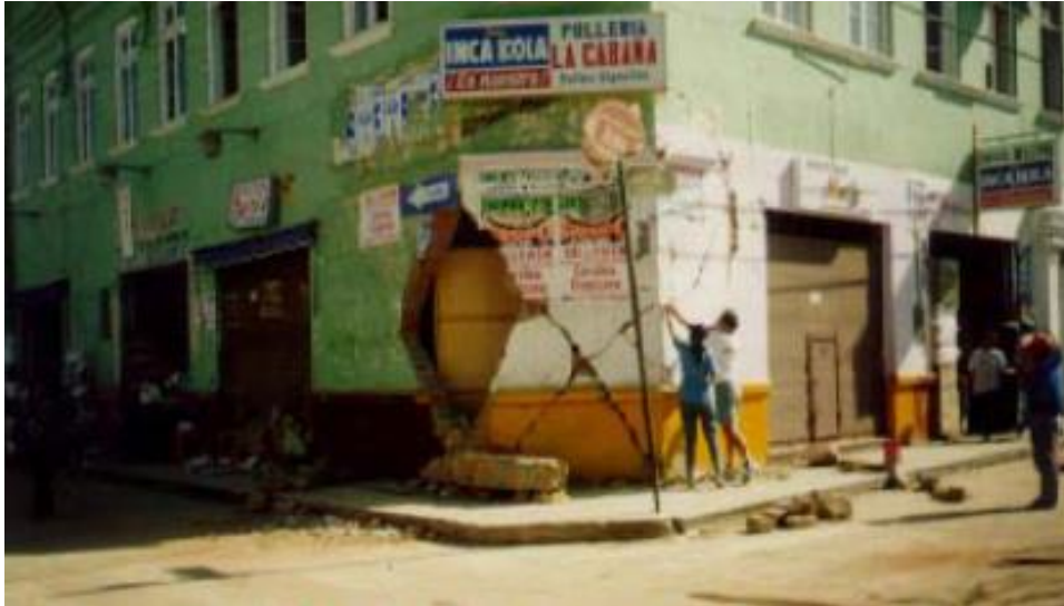
Foto 7: Imagen de una esquina que ha sido afectada por una acción sísmica. Fuente: Manual de configuración y diseño sísmico de edificios.
