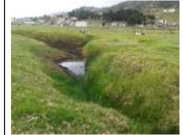
Foto N°26 Pérdida de cause por acumulación de sedimentos.
