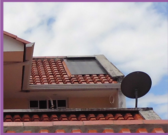
FOTO #47 VIDRIO EN CUBIERTA DESDE FACHADA FRONTAL
