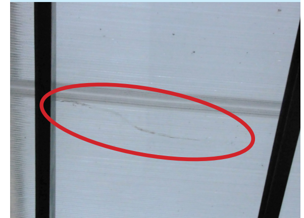
FOTO #14 FISURA EN POLICARBONATO
