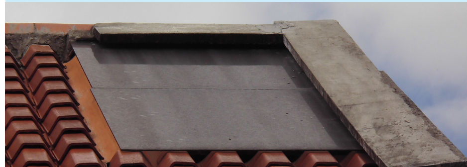
FOTO #34 LAGRIMERO OBSTACULIZANDO SALIDA DE CALOR
