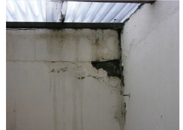
FOTO #17 DAÑOS EN EDIFICACIÓN
