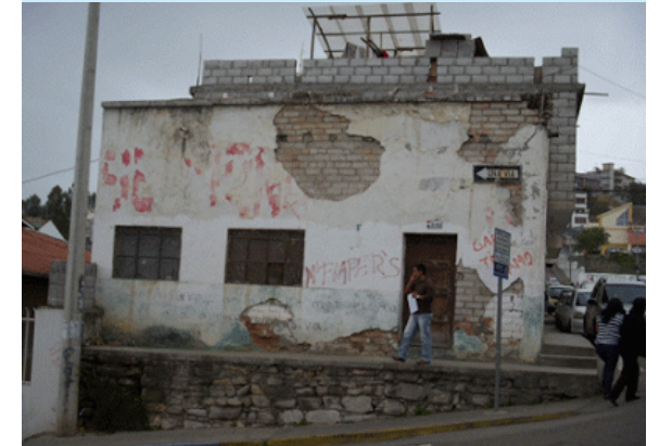
FOTO #24 VIVIENDA EN CAÑAR, NO CUMPLE CON LOS COMPONENTES NECESARIOS DE HABITABILIDAD
