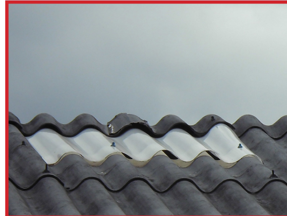
FOTO #42 PLANCHAS ONDULADAS, MALA COLOCACIÓN
