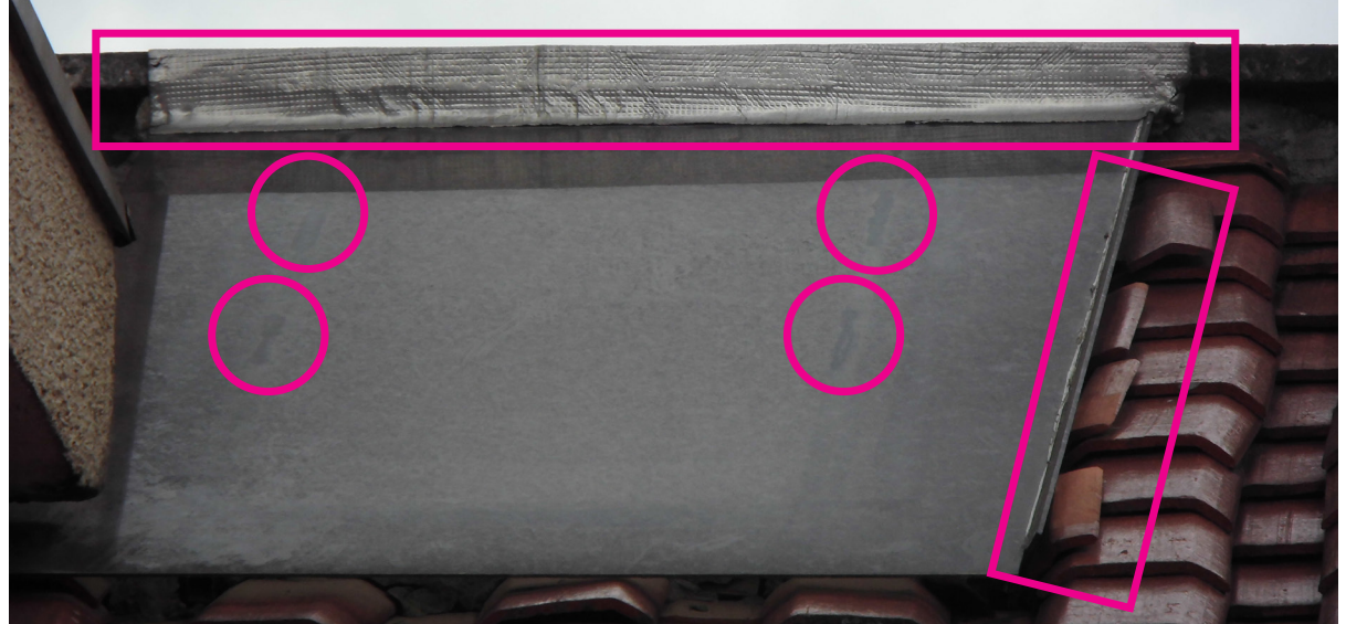
FOTO #33 IMPERMEABILIZANTE OBSTACULIZANDO SALIDA DE CALOR
