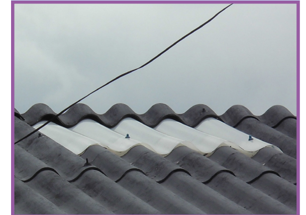
FOTO #43 PLANCHAS ONDULADAS, MALA COLOCACIÓN
