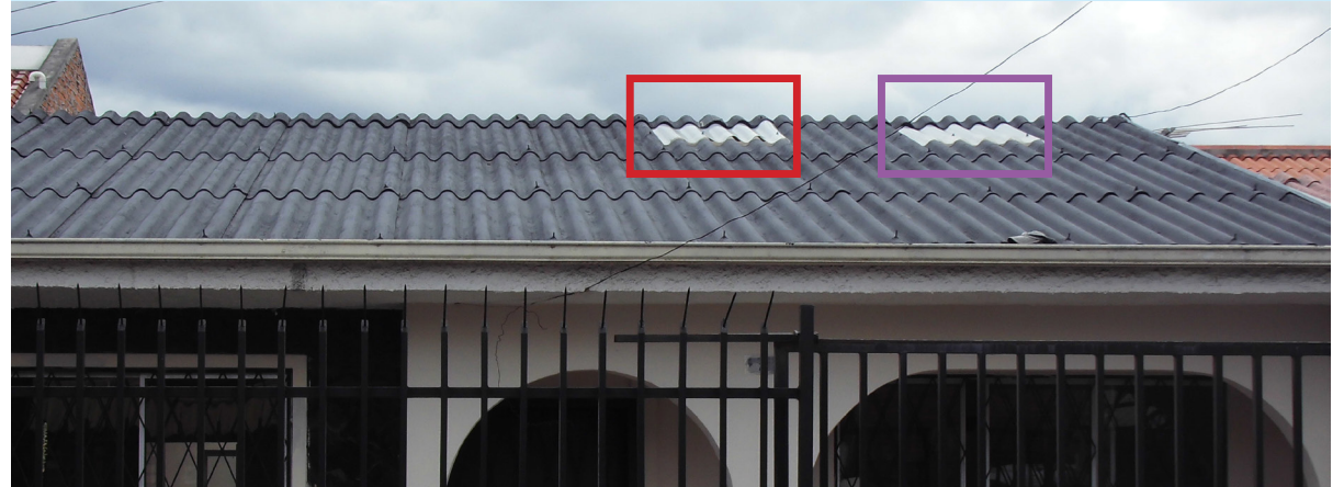
FOTO #41 PLANCHAS ONDULADAS EN CUBIERTAS TRANSLUCIDAS DE VIVIENDA UNIFAMILIAR
