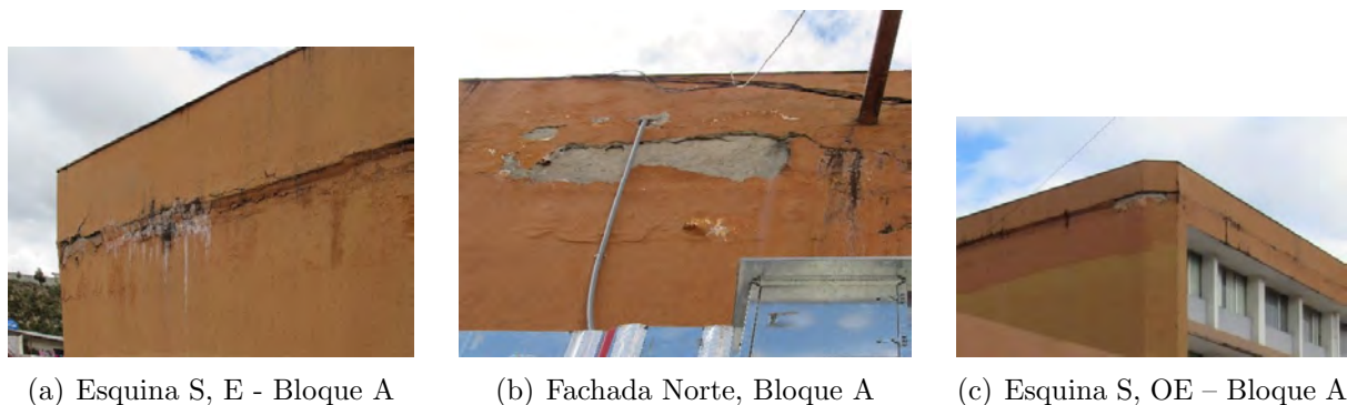
FIGURA 2.36: Deterioro en fachadas
