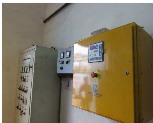
(b) Sistema automatizado/encendido del generador
