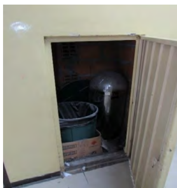
(b) Ducto 2 con basura
