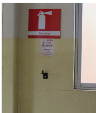
(c) Gancho sin extintor
