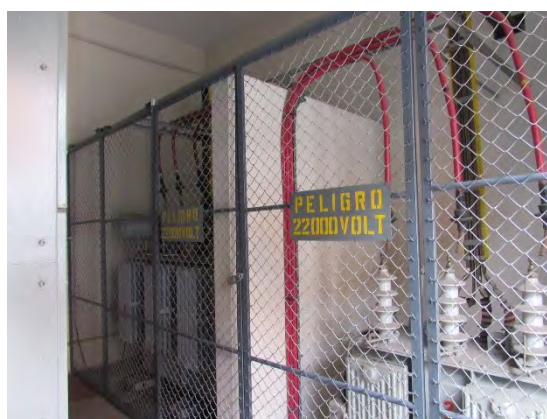
(b) Cabina de Transformadores
