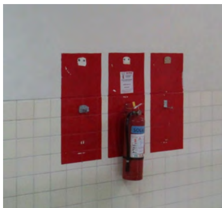
(b) Ganchos sin extintores, Quirófanos
