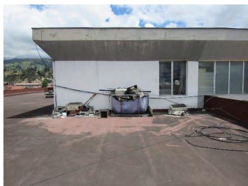
(a) Acumulación de equipos, Bloque A
