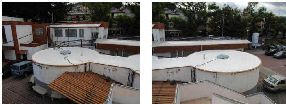
(a) Tanque 1 de abastecimiento directo (b) Tanque 2 abastecimiento de reserva
