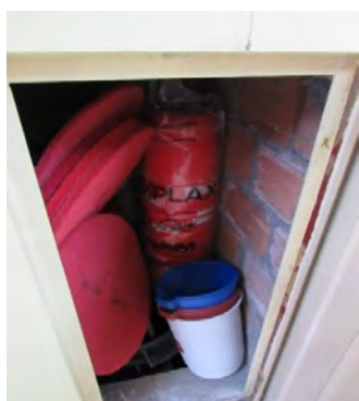
(a) Ducto 1 con Basura
