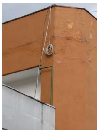
(d) Cable en fachada
