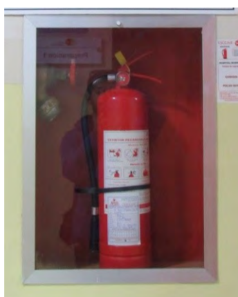
(a) Extintor en Gabinete
