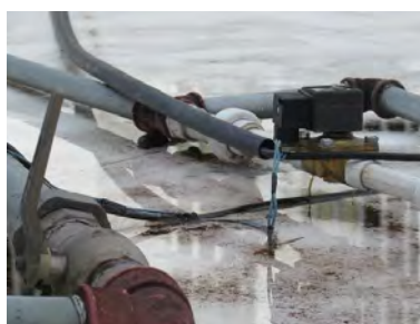
(b) Cable sobre reservorio
