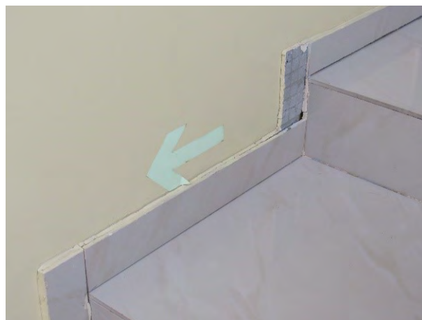
(b) Desprendimiento / barretera consulta externa
