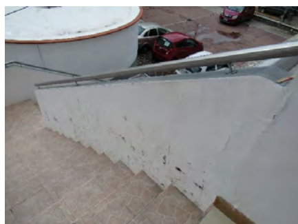
(d) Humedad Gradass Administracón Bloque C
