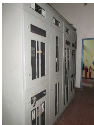
(a) Tablero eléctrico
