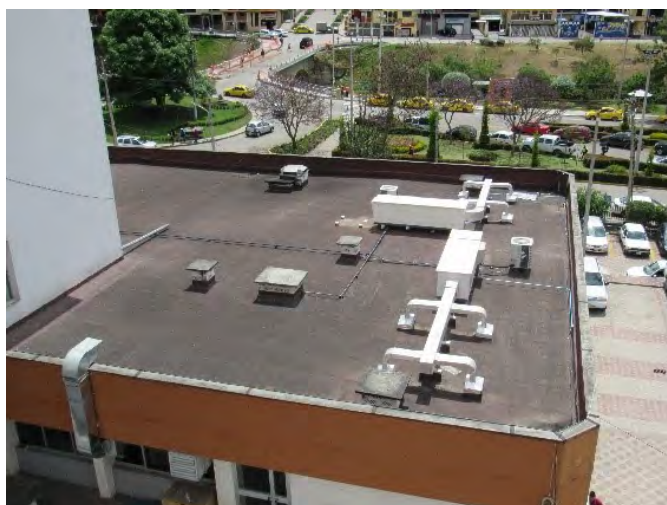
FIGURA 2.23: Sistema de Aire acondicionado en terraza
