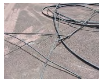
(c) Cables pelados en terraza
