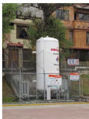
(a) Tanque de oxígeno de 5000l
